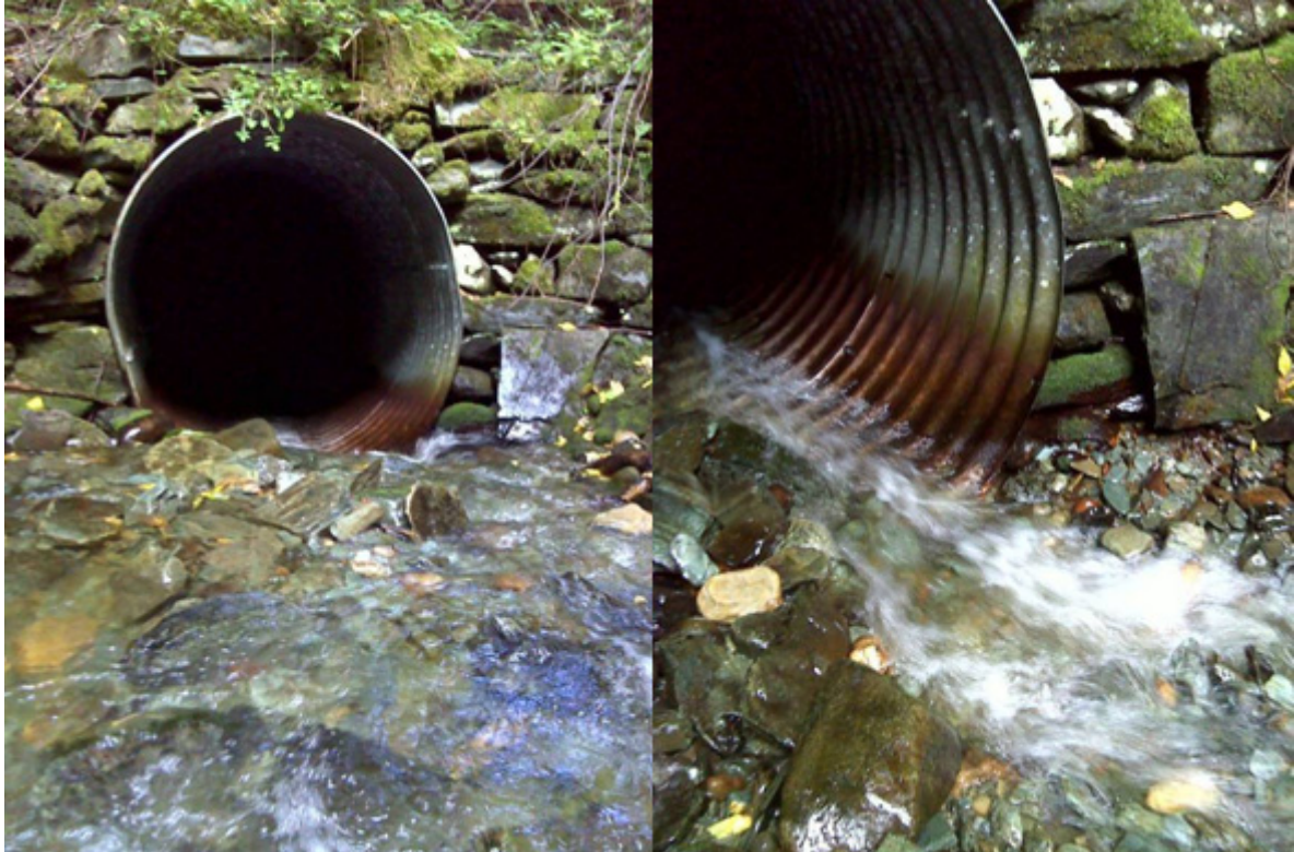
Figur 3. Kulvert under grusvei og jernbane i Bjørkbekken. Foto: Morten A. Bergan
