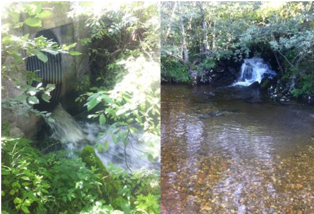
Figur 16. Kulvert under RV 30 i Havsbakkbekken. (Foto: Morten Andre Bergan)
