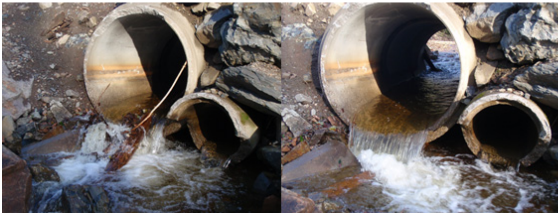
Figur 18. Kulvert ved munning av Svartorseterbekken til Langlielva. Kulverten har litt sprang selv på høy vannføring i Langlielva, og kan tettes av trevirke (t.v.), som NIVA fjernet (t.h.). Fisk kan imidlertid vandre forbi i perioder hvor Langlielva har høy vannføring. Foto: M. Bergan
