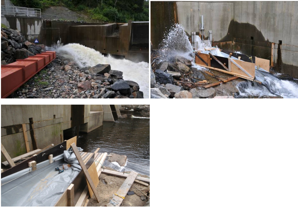
Figur 4. Venstre figur. Vannsprut ut av renseluke før denne ble dempet med bruk av en OB Wik-presenning. Høyre figur. Vann ut fra spyleluke er samlet inn i en OB-Wig-presenning og ledet til en åleruse montert på utløpet av presenningen. Nederste figur viser renna uten vann. Foto: F.Kroglund/J.Guttrup.
