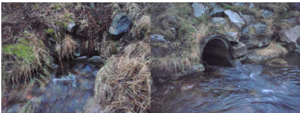
Figur 45. Lekkasje gjennom veiforbygningen (t.v.) og kulvertutløp (t.h.) på høy vannføring ved Fv 210.
