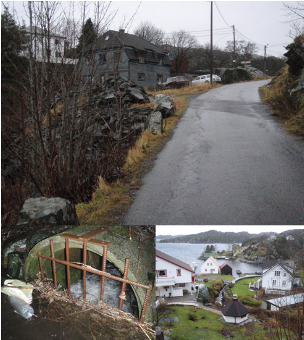
Figur 51. Bekk ved Møvik er lagt under bakken (øverst) i betongkulvert (under t.v.) som av flere årsaker er vandringshindrende.
