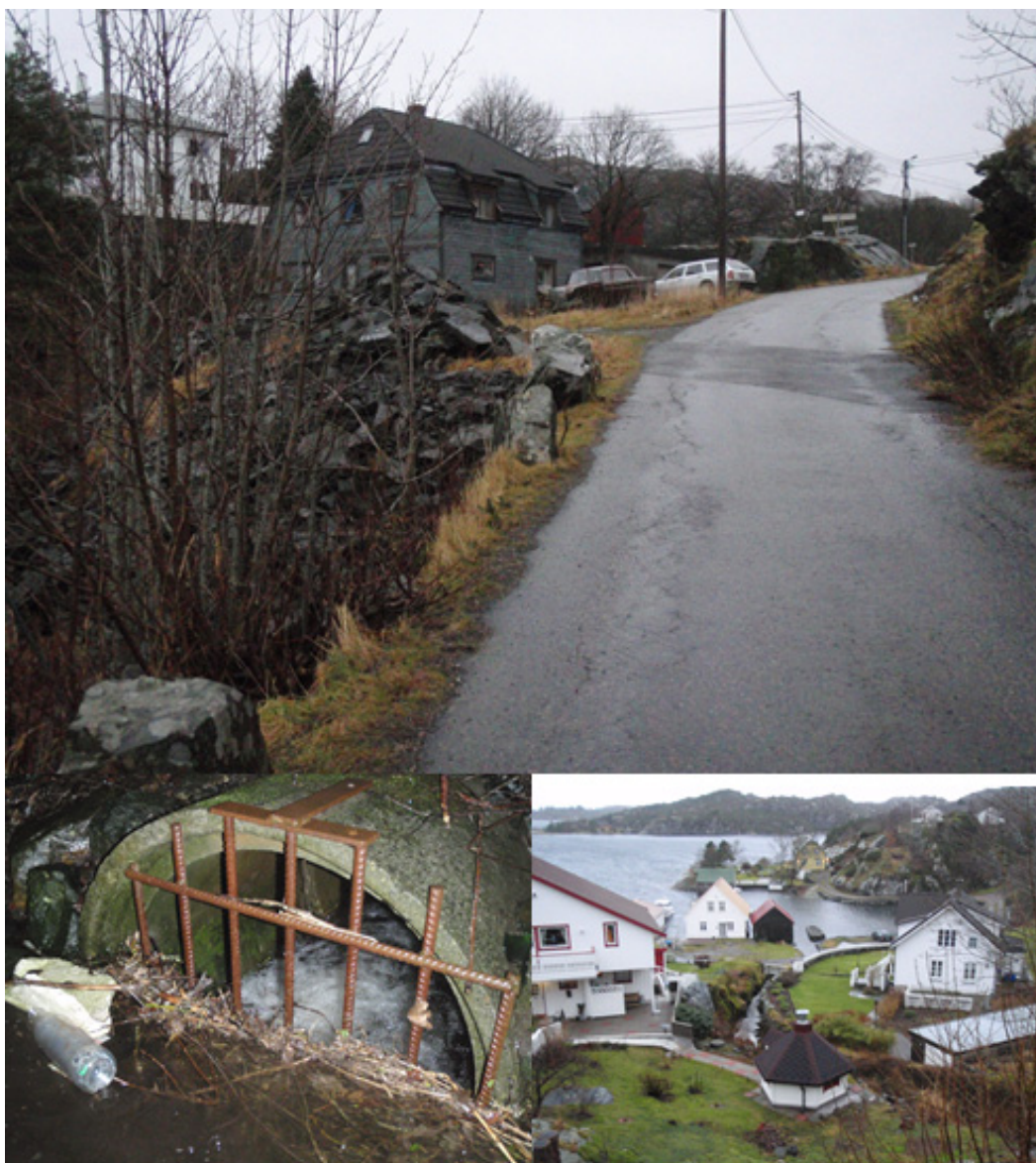
Figur 51. Bekk ved Møvik er lagt under bakken (øverst) i betongkulvert (under t.v.) som av flere årsaker er vandringshindrende.
