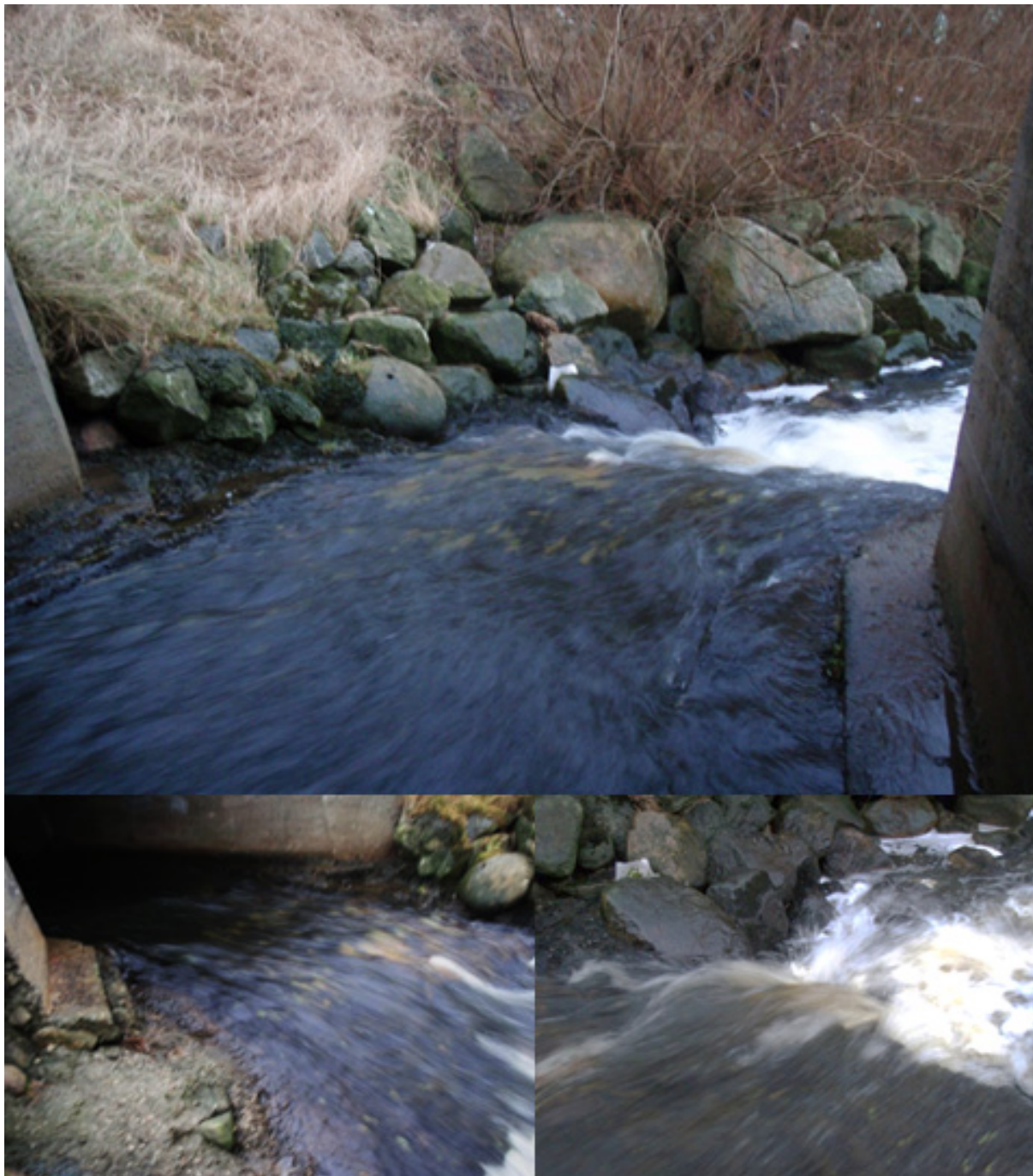
Figur 30. Krysning under bekk ved Husvegg, med murt betongbunn, har skapt et vandringshinder for laksefisk og må utbedres.
