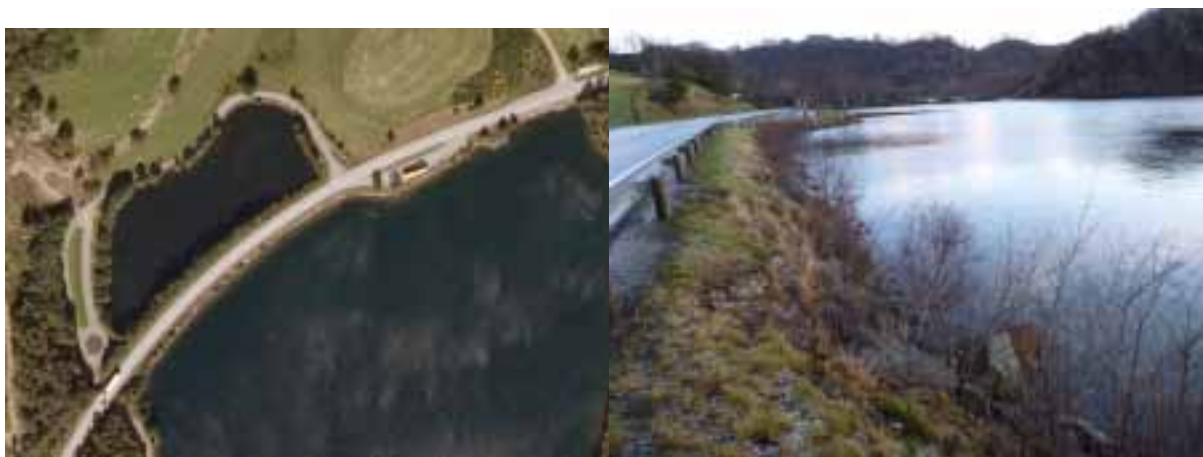
Figur 24. Avsnørt bukt i Saglandsvatnet har liten vannutskiftning. Det går et ca. 60 cm rør omkring midt i fyllingen vist som et rustent jernrør nederst til høyre i bildet (sett mot nordøst).
