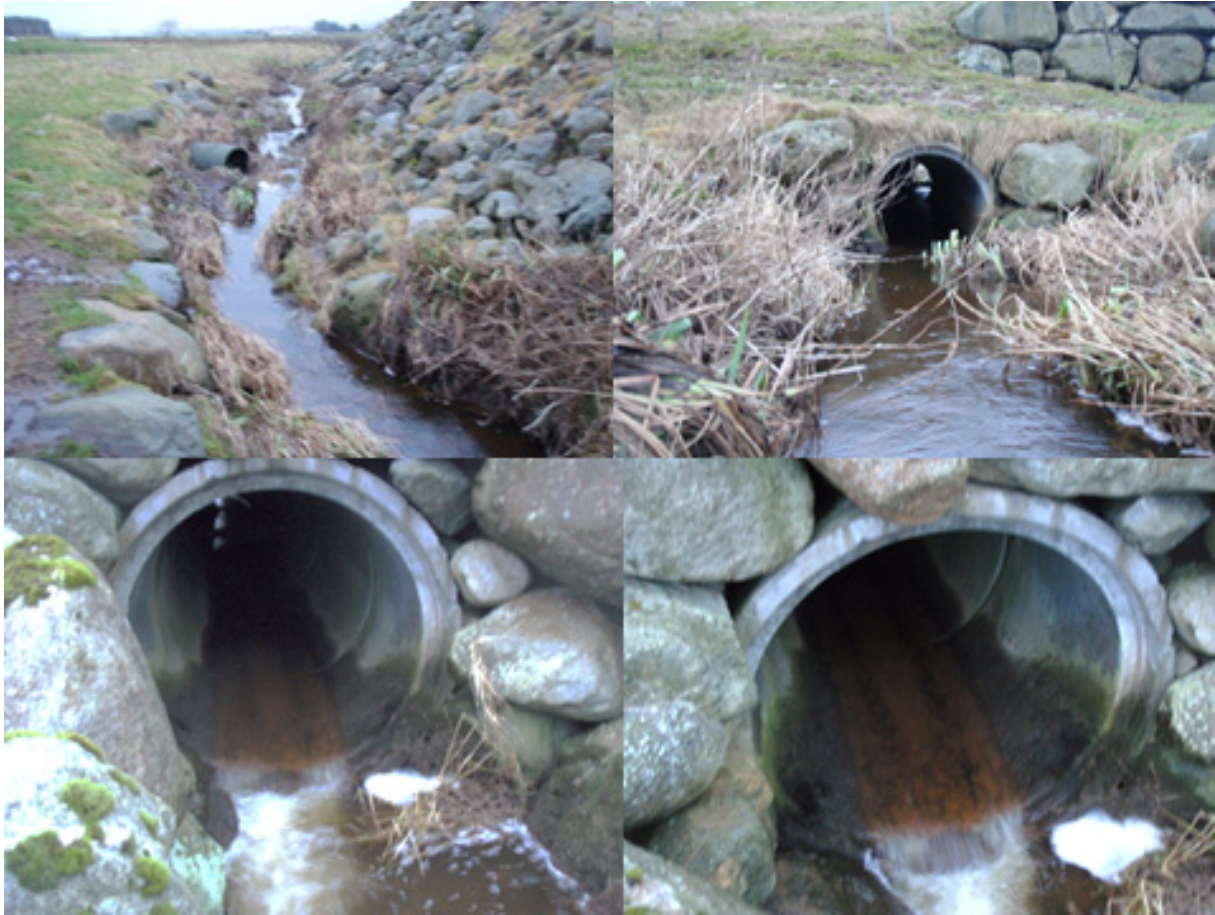
Figur 29. Grødalandsbekken, med kryssing under Fv 44 ved rund betongkulvert som ikke tilfredsstillende utført for fiskevandring.
