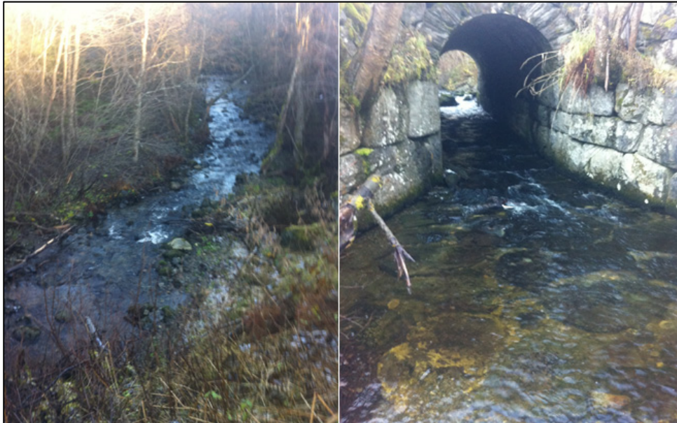
Figur 16. Druggu, med tilfredsstillende krysning for vandring av anadrom laksefisk under Fv65. Foto: Morten Andre Bergan.
