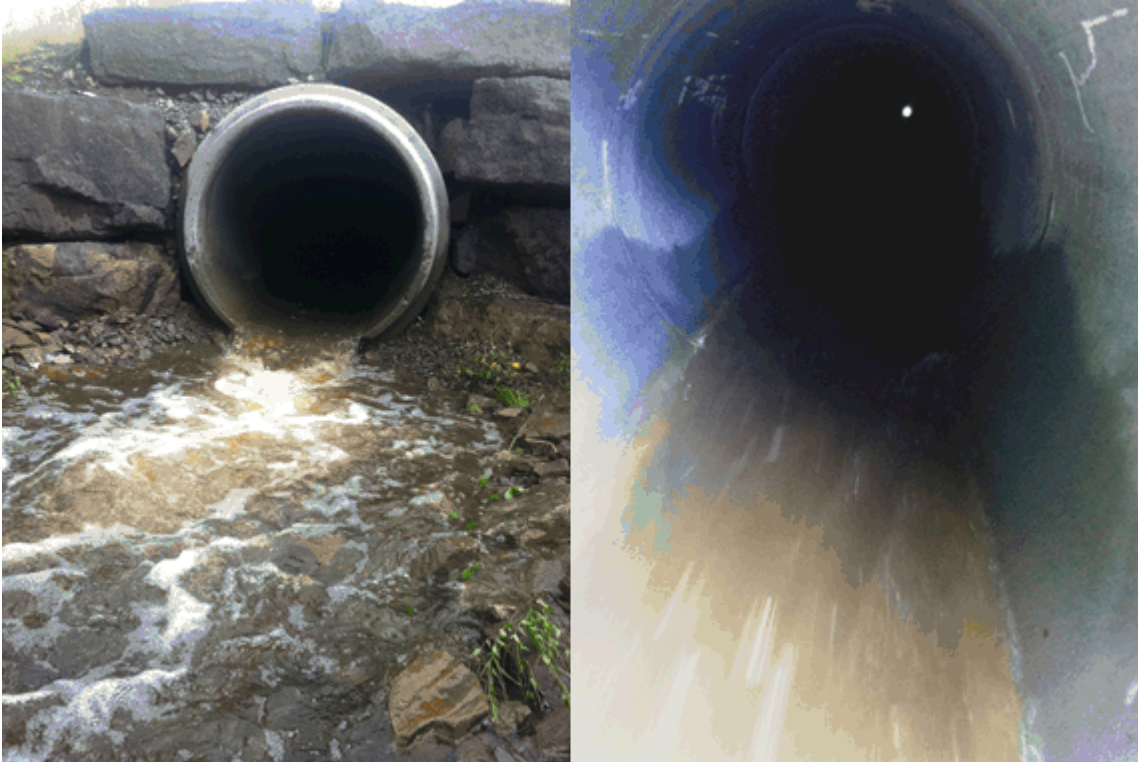
Figur 21. Nyanlagt kulvert under ny trase mellom Barkåker og Tønsberg. Resultatene fra denne undersøkelsen indikerer at sjøørret ikke kan passere, og viktige gyte- og oppvekstområder lenger opp i bekken er å anse som tapt. Høyre bilde viser innsiden av betongrøret.
