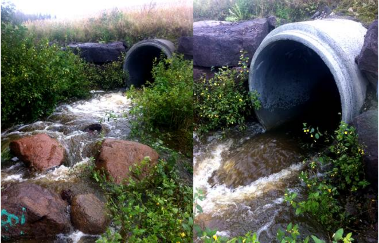
Figur 20. Nyanlagt kulvert i Homannsbekken på høy vannføring i 2011 etter endt anleggsarbeid. Jernbaneverket har gjort forsøk på tiltak, ved å legge ut stor stein nedstrøms kulvertmunningen, sannsynligvis for å få hevet vannspeilet, slik at gytefisk kan passere. NIVA kan ikke se at tiltaket har bedret oppgangsmulighetene nevneverdig.
