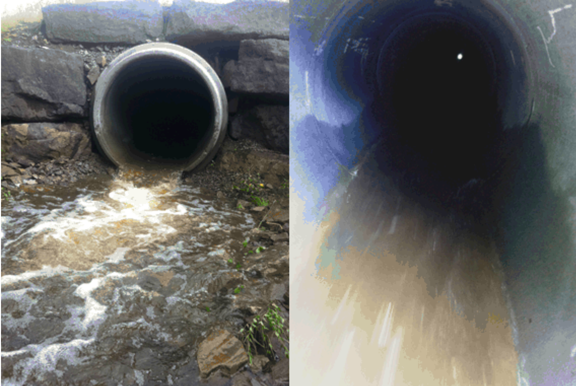
Figur 21. Nyanlagt kulvert under ny trase mellom Barkåker og Tønsberg. Resultatene fra denne undersøkelsen indikerer at sjøørret ikke kan passere, og viktige gyte- og oppvekstområder lenger opp i bekken er å anse som tapt. Høyre bilde viser innsiden av betongrøret.
