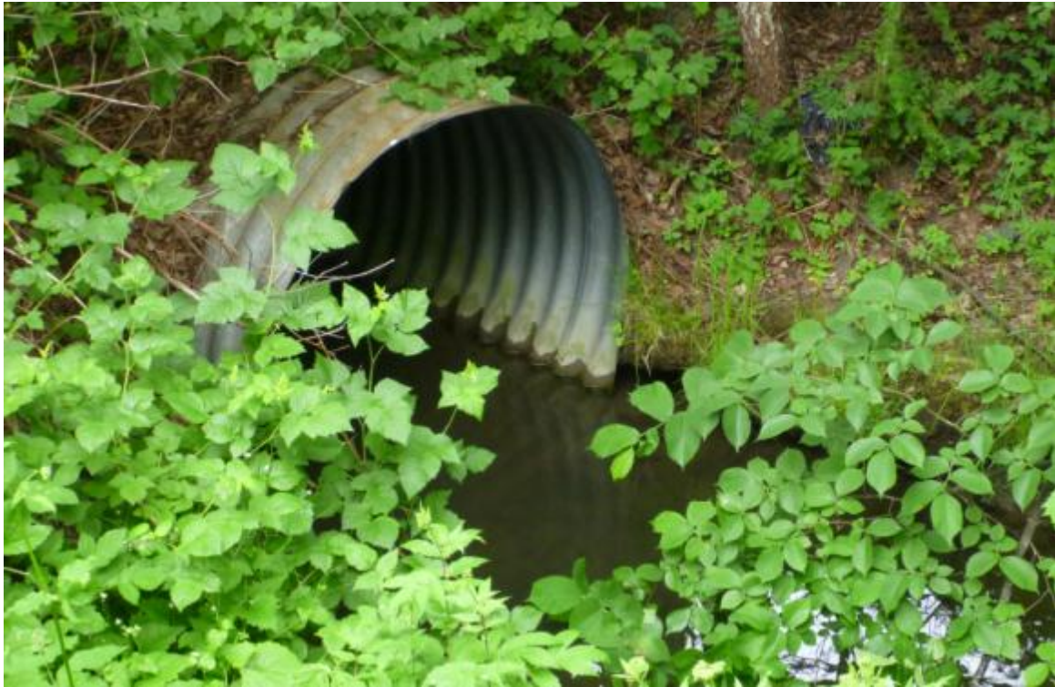
Figur 13. Godt nedsenket blikk-kulvert (3). Foto: NIVA
