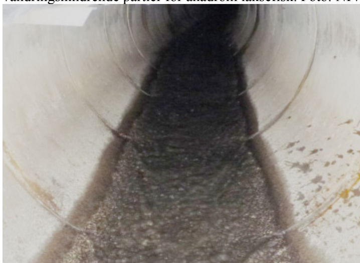
Figur 6. Lange strekninger med lav vanndybde i betongkulverten. Foto: NIVA
