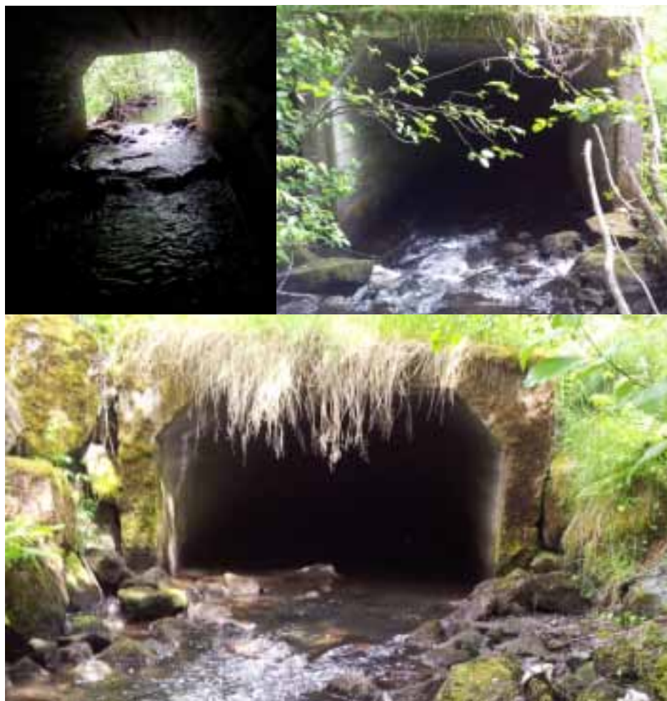
Figur 91. Kulvert (innside øverst til venstre, innløp øverst til høyre og utløp under) i forbindelse med krysning under T-banelinja ved Grorud (29). Foto: NIVA
