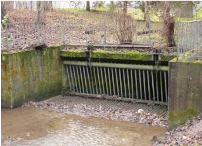
Figur 17. Rist foran inngang til kulvert (1) under Ring 3. Foto: Bymiljøetaten.
