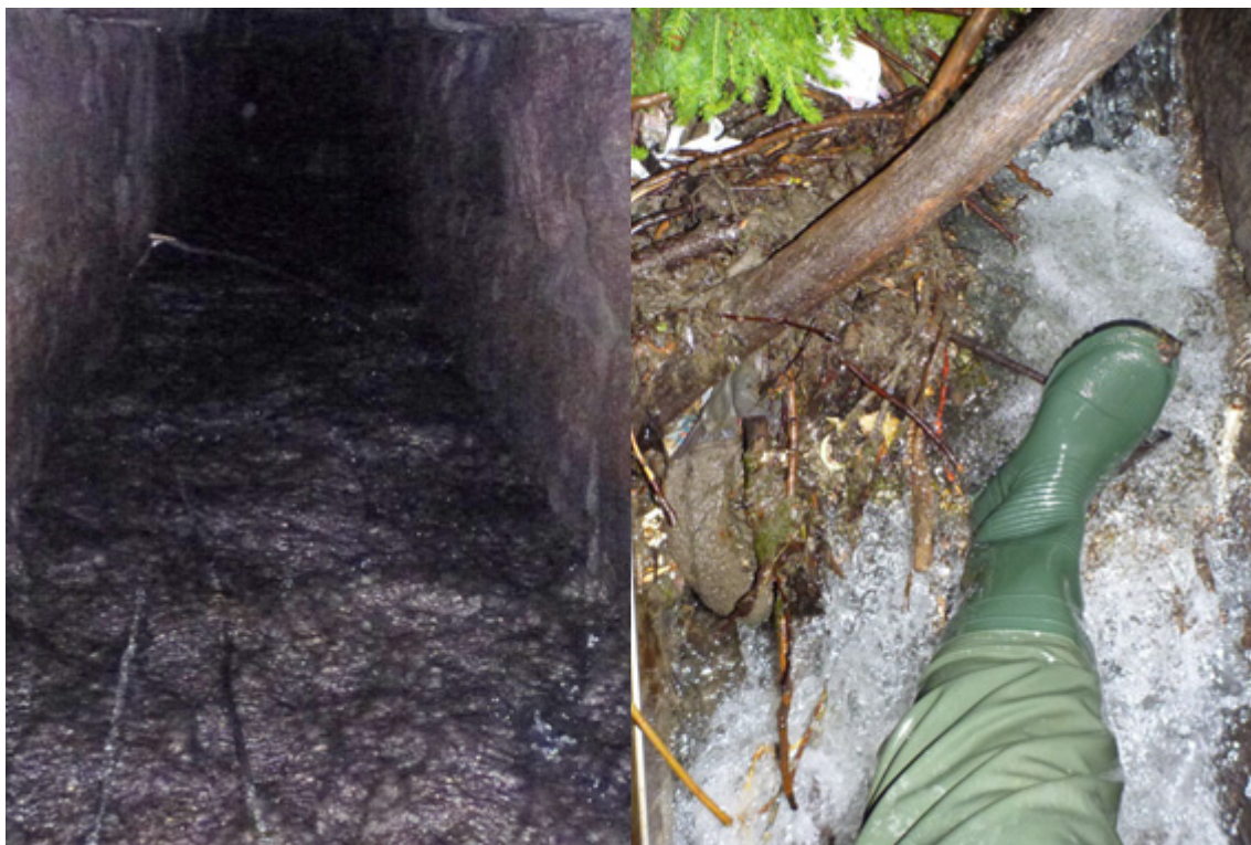
Figur 15. Flat steinbunn med lav vanddybde over en lengre strekning (t.v.). Vannstandssprang og tetting av greiner/kvist ved overgangen til betongrør (t.h.) under jernbane (3). Foto: NIVA.
