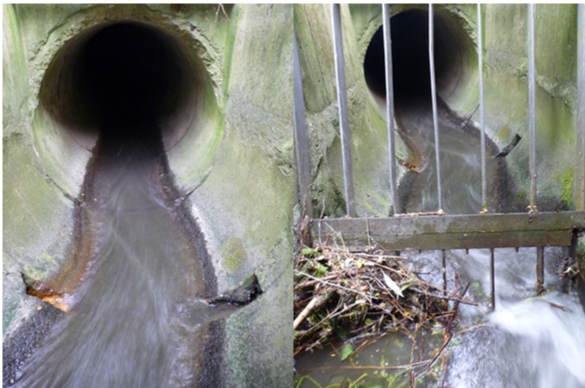
Figur 8. Videre nedover inngang under E 18 (1b). Dette partiet kan være kritisk for oppvandrende laksefisk som følge av lav vanndybde og svært hurtig vannhastighet.
