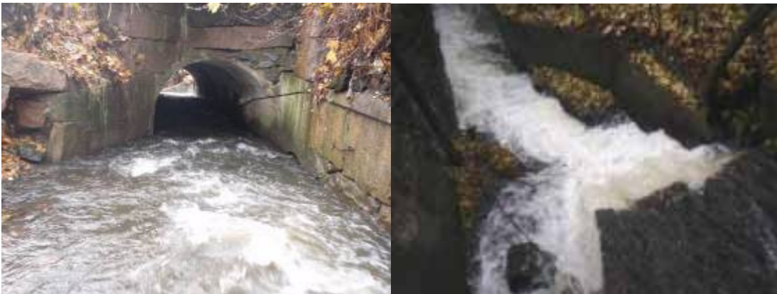
Figur 55. Krysning under Slemdalsveien (6). Et overheng (til høyre) av asfalt (?) skaper for høyt fall i forhold til det naturlige fallet, og hindrer evt. oppvandring av fisk i alle aldersklasser innad i avsnittet. Foto: NIVA
