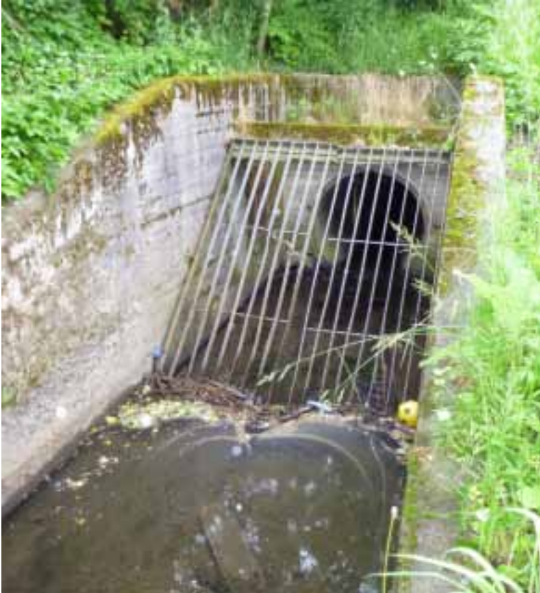
Figur 66. Kulvert under Refstadveien (1), der bekken går i en lengre lukking nedstrøms. Foto. NIVA
