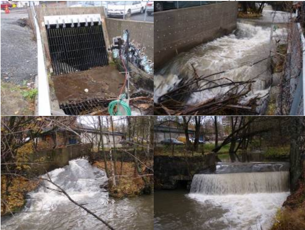
Figur 79. Kulvert under Enebakkveien i Alna, med terskel (5) umiddelbart oppstrøms denne. Foto: NIVA
