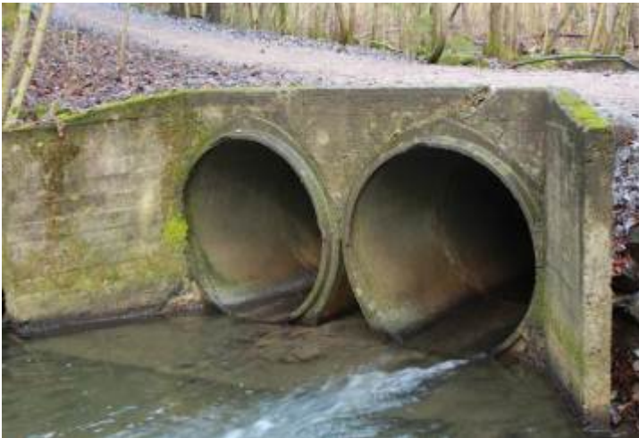
Figur 19. Stikkrenne i rund betong (3). Foto: Bymiljøetaten.
