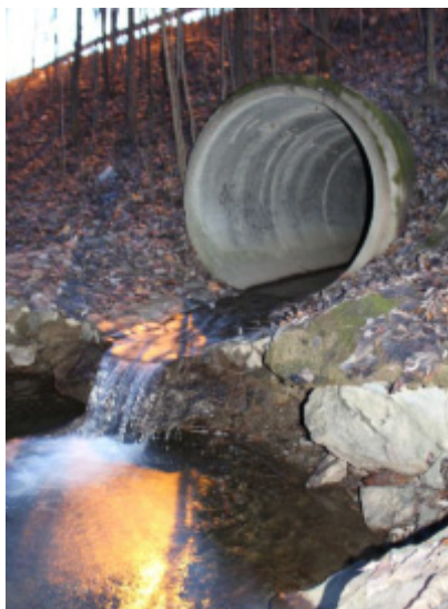
Figur 32. Høyt sprang og lav vanddybde i kulvert/lukking i Makrellbekken under Hoff sveien (2). Foto: Bymiljøetaten.
