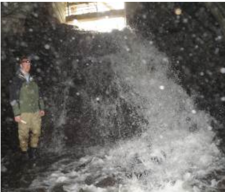
Figur 103. Fall på 2+ meter i fjelltunnellen under Hauketo (1). Foto: Hjalmar Eide.
