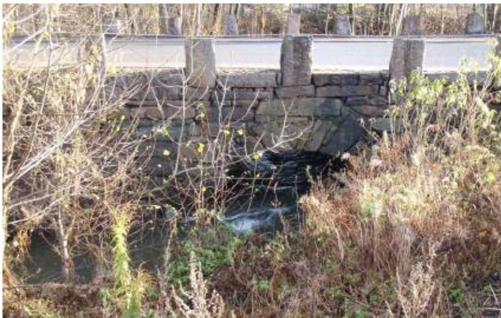
Figur 85. Tilfredsstillende veikrysning under Kalbakkveien (26) nedstrøms ALN2, der bekkesenga er bevart og kulverten er like bred som naturlig elveleie. Foto: NIVA
