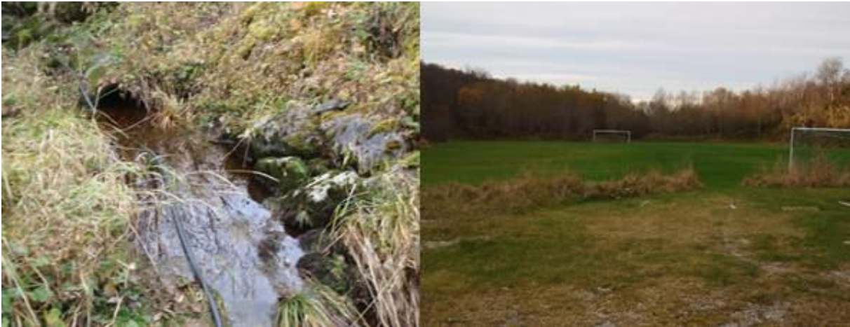
Figur 57. Kulverten under fotballbane (t.h.) i en underdimensjonert, rund betongkulvert.
