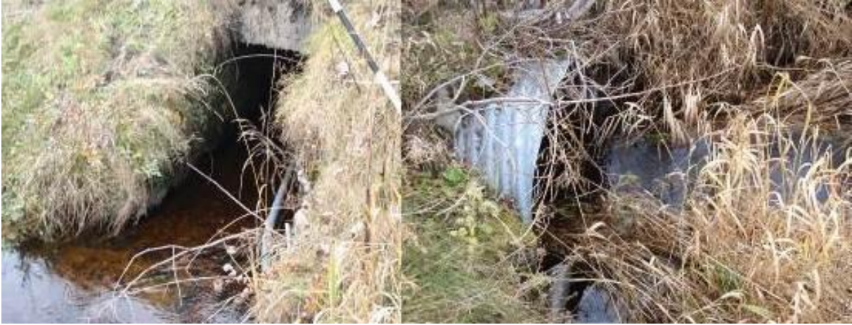
Figur 56. I retning sørvest går tilsigsbekken til Hundvatnet under FV 714 i en kulvert med bevart bekkebunn, som ivaretar fiskevandring. Foto viser kulvertens inn- - (t.h.) og utløp (t.v.).
