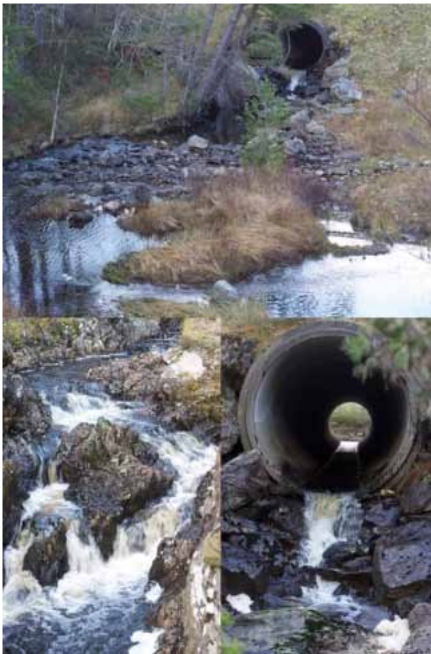
Figur 100. Kulvert under Fv 381 i Merkesåa (øverst og nederst t.h.), og naturlig vanskelige (men trolig passerbare) oppgangsforhold i vassdraget nedstrøms Fv 381. (Foto: privat)
