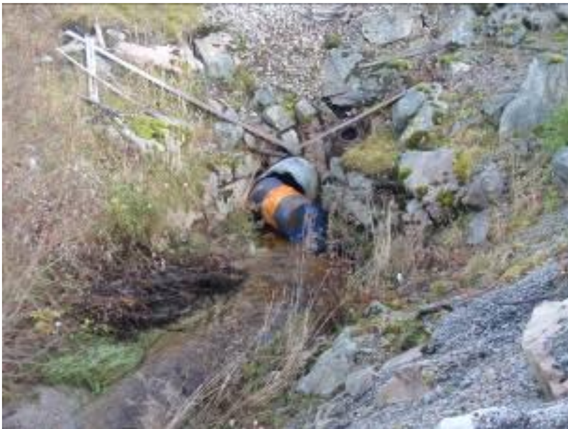
Figur 67. Innløp til kulvert under FV 714 sperret med tønne.
