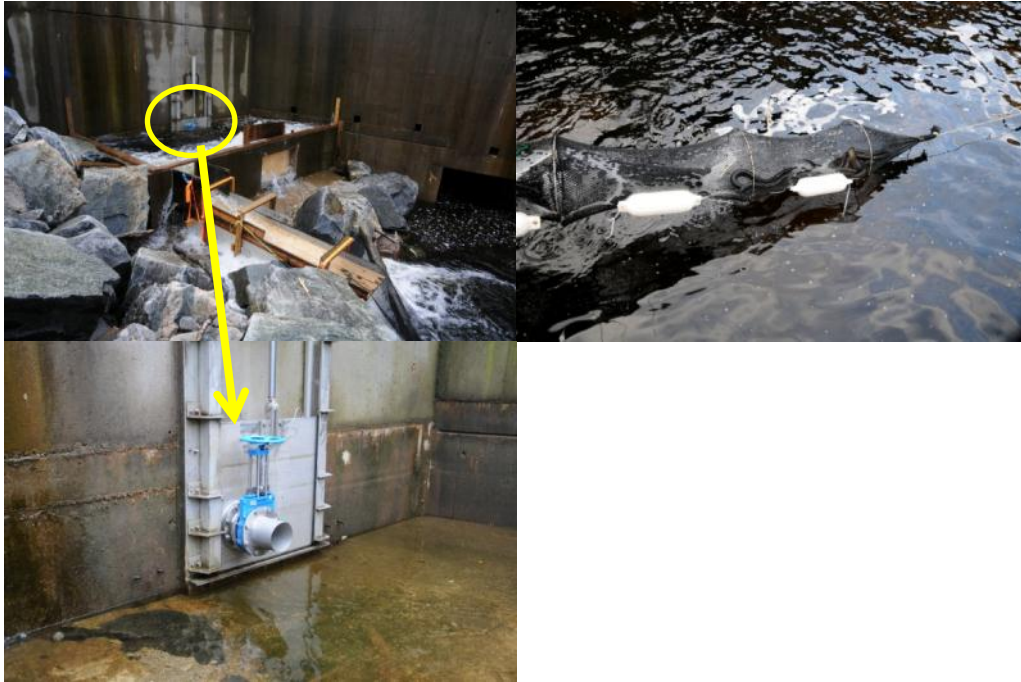
Figur 8. Fangstinnretning for ål ved Fosstveit kraftverk. Sideløp, sideløpsdam, vannavskiller (øverst til venstre). Fangstruse plassert på vannavskiller (øverst til høyre). Bunnappelluke med 200 mm hull og ventil (nederst). Plassering av sideløp i forhold til damkonstruksjonen er vist i Figur 3 . Foto: F. Kroglund
