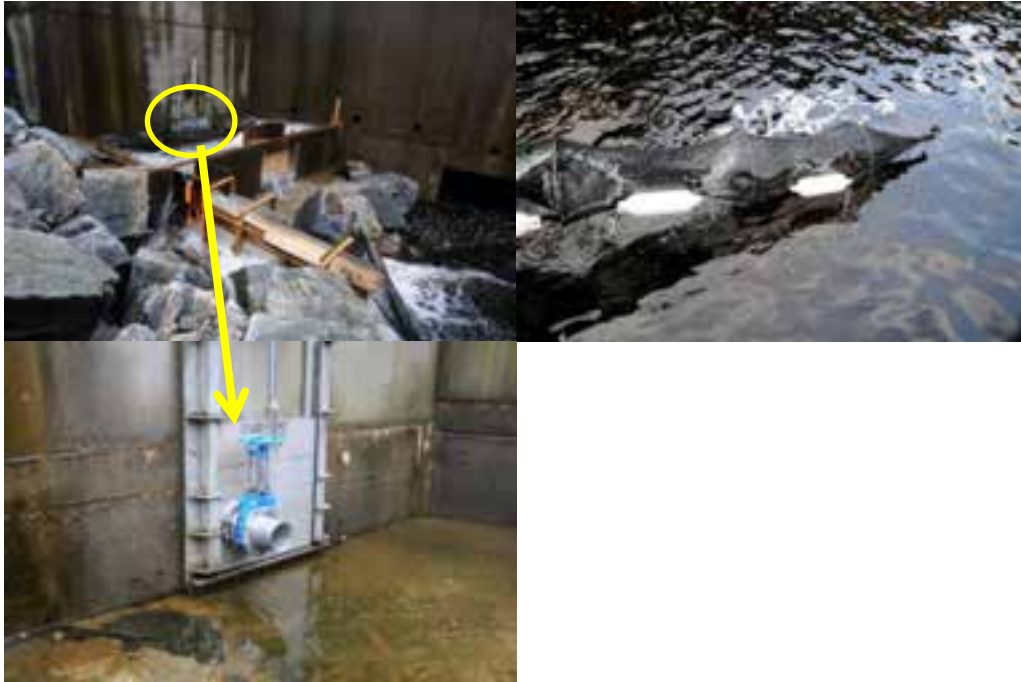
Figur 8. Fangstinnretning for ål ved Fosstveit kraftverk. Sideløp, sideløpsdam, vannavskiller (øverst til venstre). Fangstruse plassert på vannavskiller (øverst til høyre). Bunnappelluke med 200 mm hull og ventil (nederst). Plassering av sideløp i forhold til damkonstruksjonen er vist i Figur 3 . Foto: F. Kroglund
