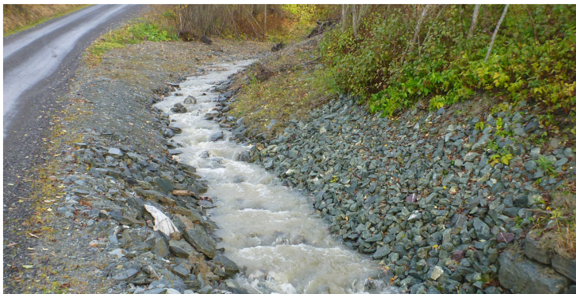
Figur 21. Stasjonsområdet i Ristelva/Høstadbekken ved Brenslan. (Foto: Morten Andre Bergan)
