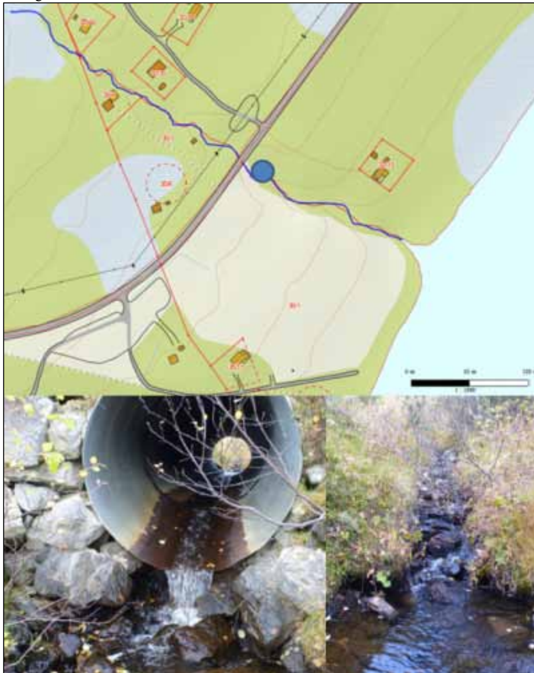
Figur 33. Kartangivelse av navnløs bekk (øverst), krysning under vei (nederst, t.v.) og bekkestrekning ovenfor vei (nederst, t.h.). (Kartgrunnlag: www.gislink.no ). Foto: M. Bergan.
