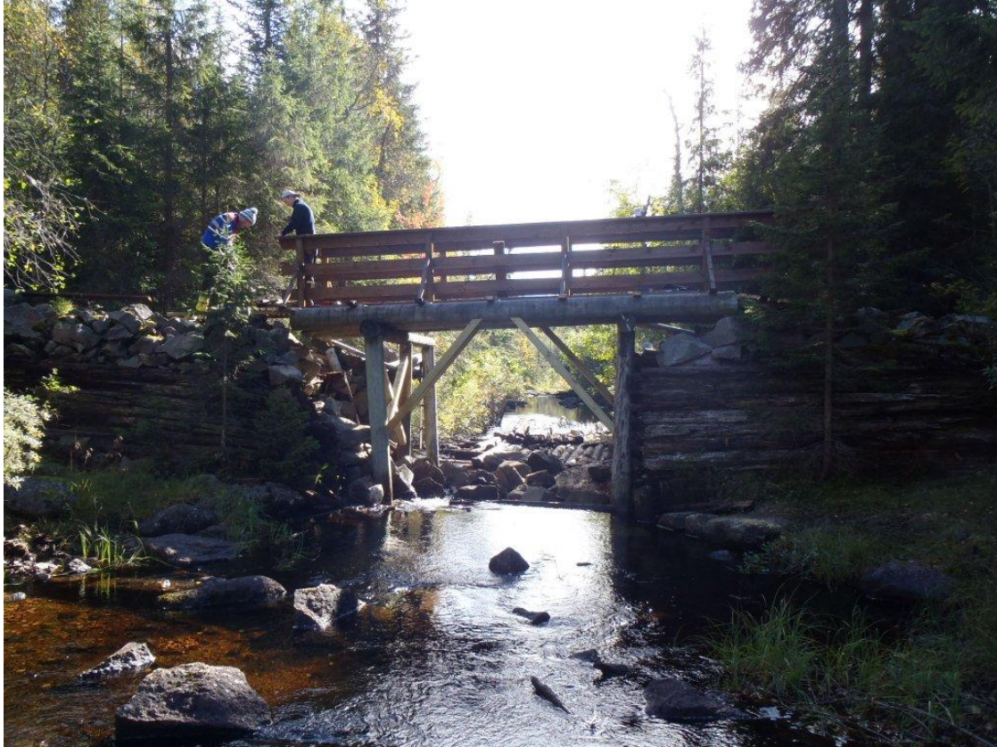
Figur 72. Sinnerdammen, en gammel steinkistedam hvor reguleringsinnmaten er fjernet. Broen over er nylig restaurert. Fisk kan gå mellom steinene. Foto: VAV.
