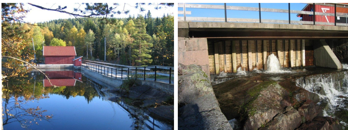
Figur 117. Skjærssjøen dam og tappeanordning. Foto: VAV.
