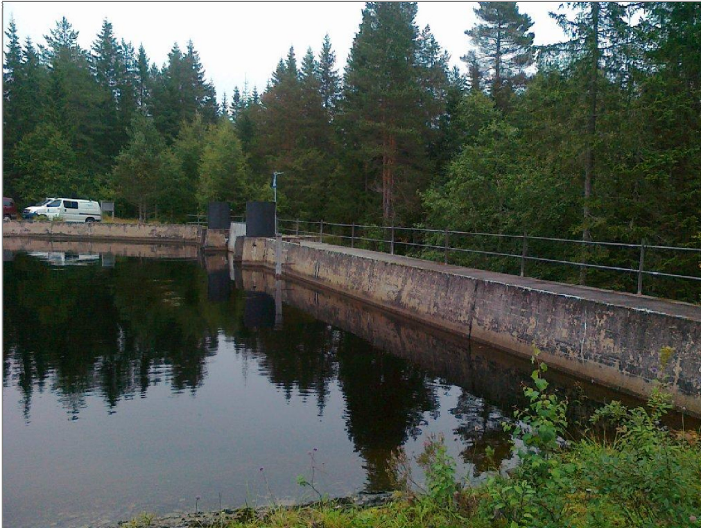
Figur 14. Storflåtán. Dammen i uløpet. Foto: Dag Berge.
