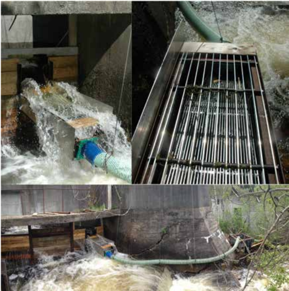
Figur 5. Sideløpsbassenget ble demt opp slik at en hadde nok fall ned mot laksetrappa (øverst V.). Wolffella hadde to rister, den øverste er bredspilet slik at smolten passerer gjennom, mens vinterstøingene passerer over (øverst H.). Fra wolffella gikk det en slange til oppbevaringskar for smolt (nederst) (Foto: T. Haraldstad).
