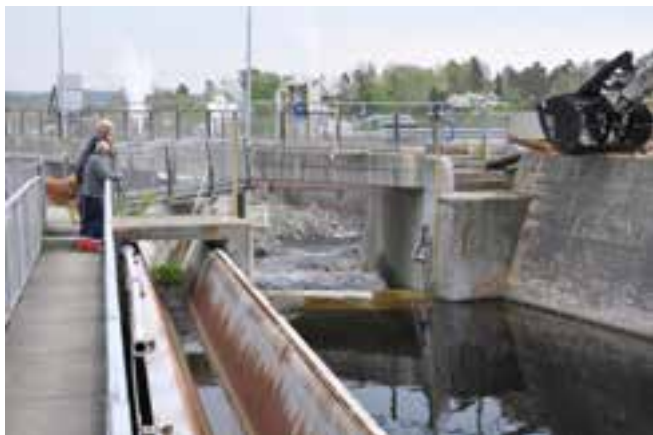
Figur 10. Isluka delvis senka 10. mai. 2011 for å slippe ut smolt. Varegrinda og inntaket til turbinen er til høyre i bildet.
