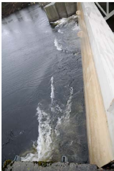
Figur 14. Bilde av turbulens ved segmentluke 3.
