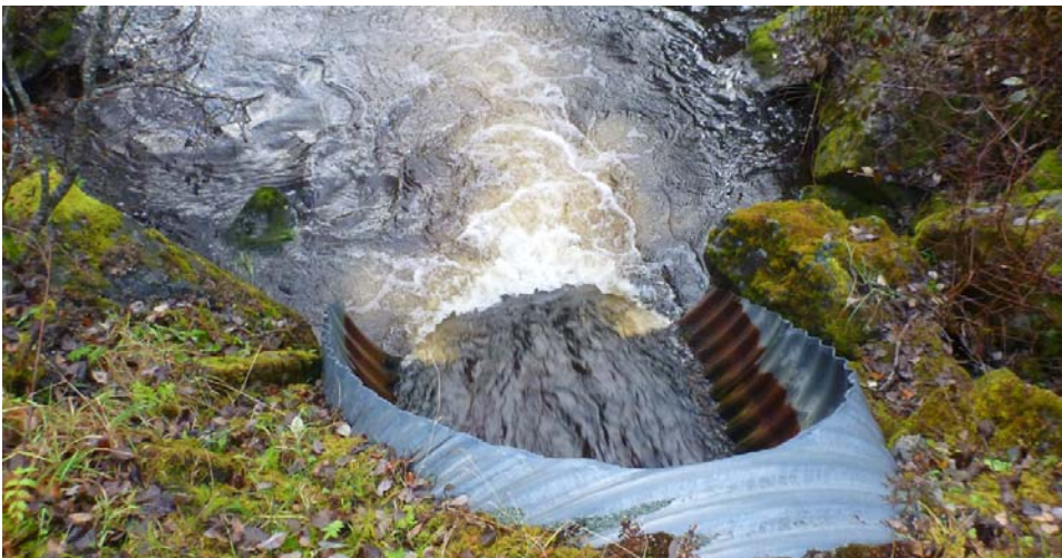
Figur 50. Kulvert under Fv 721 i øvre deler av Okla er ikke utformet på en god måte for oppgang av anadrom laksefisk, med høyt sprang og høy vannhastighet på normal eller høyere vannføring. Kulverten er passerbar for oppgangsfisk, men bør utbedres for lettere oppgang. (Foto: Morten Bergan)
