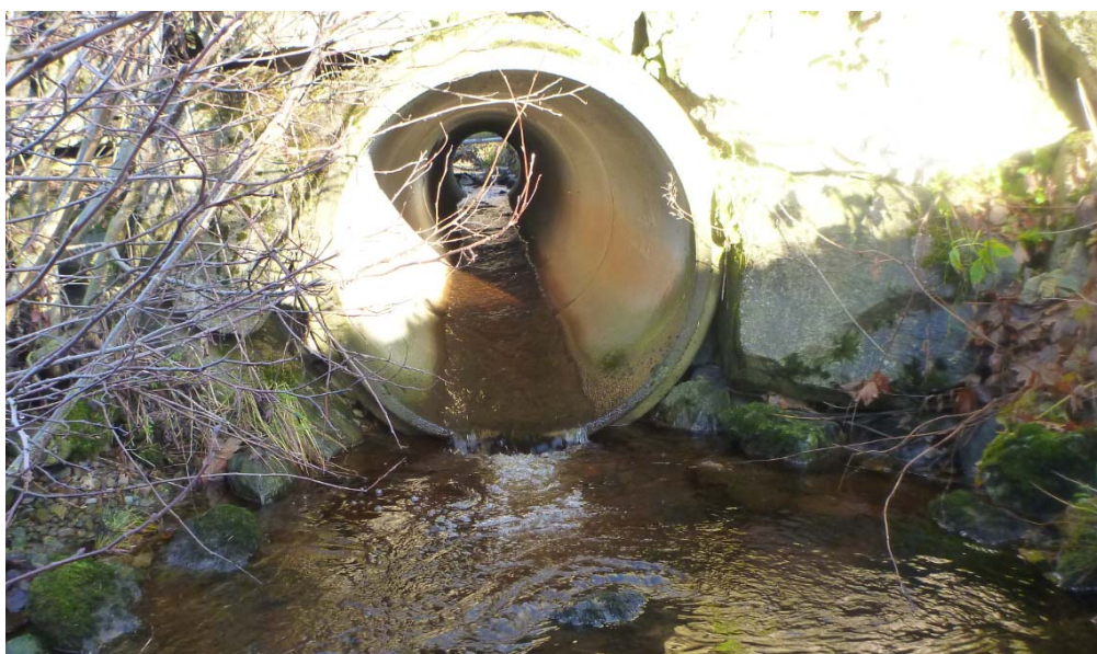
Figur 38. Veikrysning under Fv 131 for bekken fra Rotbaktjønna. Ukurant betongrør med lav vanndybde på normal vannføring. Definert som et vandringshinder for laksefisk iht. kriteriesett A i klassifiseringsveilederen. Foto: Morten Bergan.
