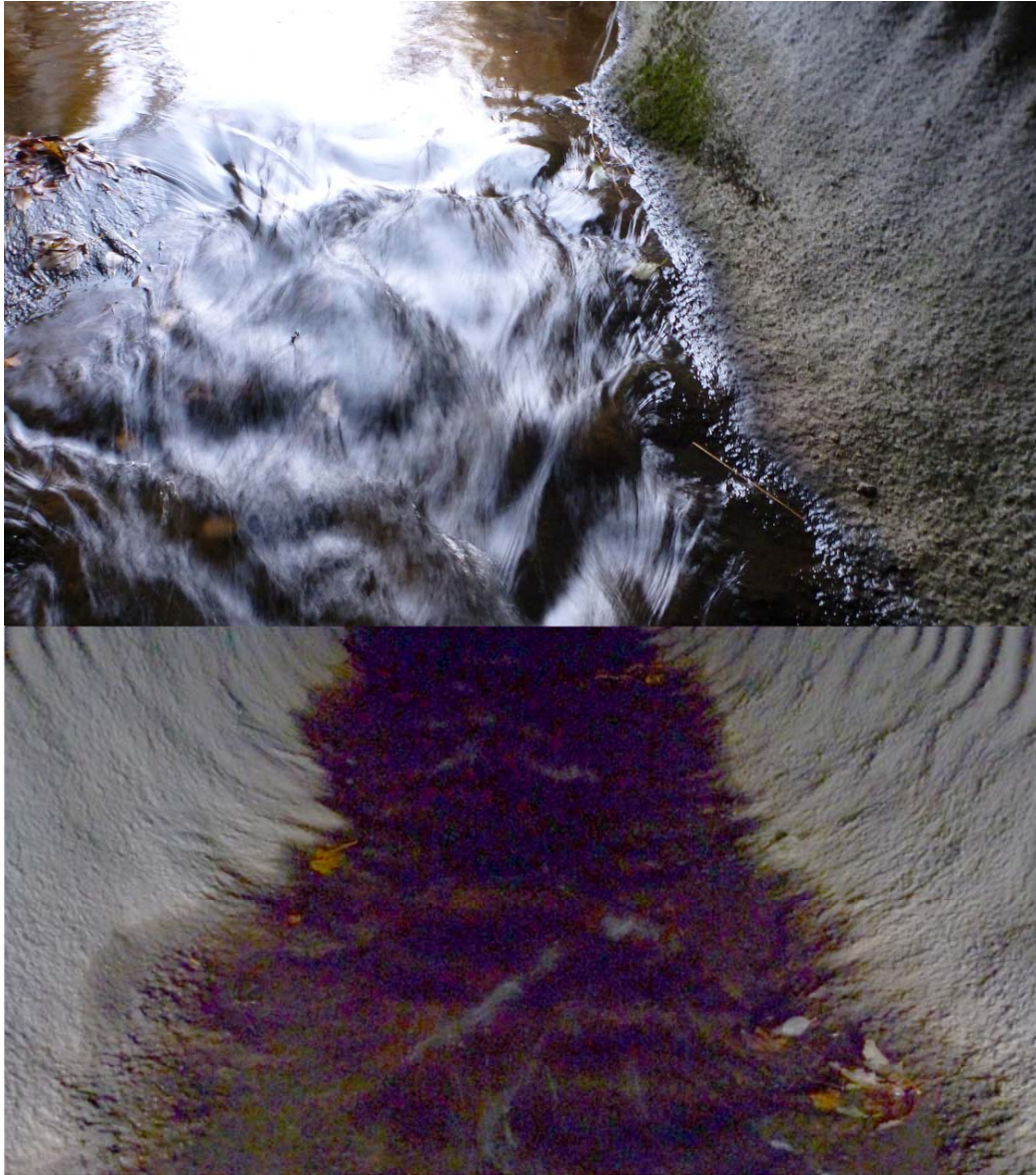
Figur 24. Det er støpt betong i bunnen av kulverten under Hasselvikveien. Dette gir høyere vannhastigheten. Det er lav vanddybde (kun få centimeter) og kulverten er lang ( \pm 65 meter), men går over en strekning som ikke har spesielt stor helning. Foto: Morten Bergan.
