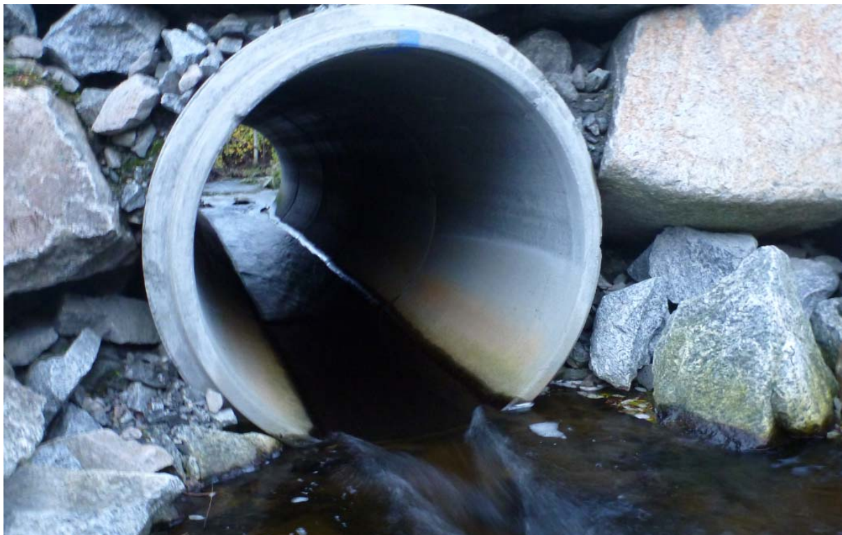
Figur 95. Nyanlagt kryssning under privat grusvei (?) er vandringshindrende for oppgangsfisk av sjørørret, men fisken kommer forbi på gunstig vannføring. (Foto: Morten Bergan)
