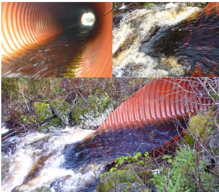
Figur 59. Kulvert under Fv 723 er fiskeførende for stor gytefisk på over middels vannføring, men vandringsvinduet er innsnevret sammenlignet med naturtilstand. (Foto: Morten Bergan)
