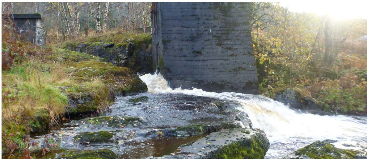
Figur 45. Oppgangsforholdene for anadrom laksefisk fra Bottengårdselva til Brekkvatnet må gjøres lettere, da årsakene er menneskeskapt både ved den eldre demningen og ved FV 710. (Foto: Morten Bergan)
