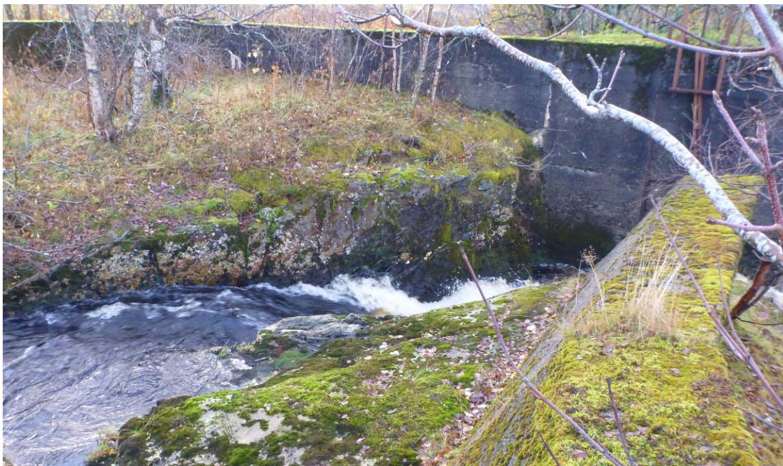
Figur 43. Eldre konstruksjon (demning) står i dag uten funksjon, men bidrar til vanskelige oppgangsforhold for anadrom laksefisk. (Foto: Morten Bergan)
