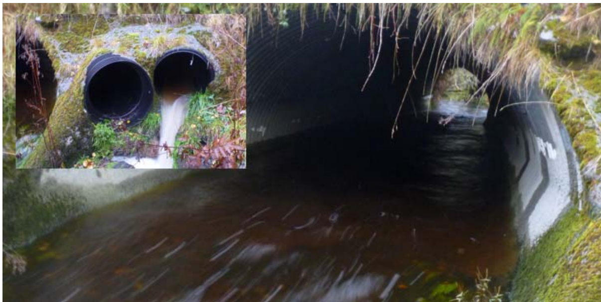
Figur 55. Kulvert under Fv 50 har tilfredsstillende vandringmuligheter for de fleste fiskestørrelser. Innfelt: Overløpsrør fra området rundt Mekonomen/Trønderbilene AS fører sanitært avløpsvann og oljeholdige substanser ut i Hubekken. (Foto: Morten Bergan)
