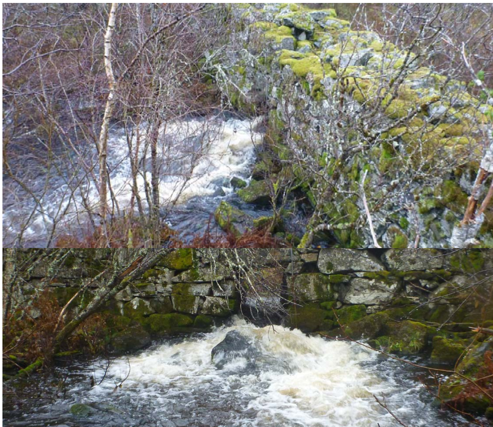
Figur 51. Den eldre steindemningen har for smal passasje, slik at det blir svært høy vannhastighet ved passeringspunktet. Oppgangsforholdene er atskillig forverret sammenlignet med naturtilstand, men stor gytefisk kan passere. Avbøtende tiltak bør allikevel utføres. (Foto: Morten Bergan).
