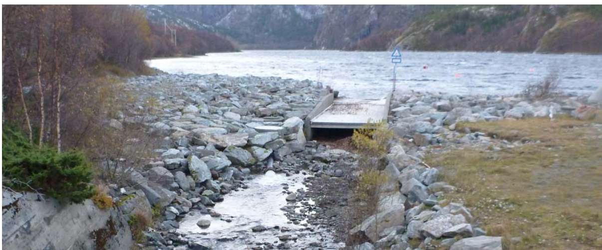
Figur 68. Fiskesperre stopper oppgang til Vikvatnet. (Foto: Morten Bergan).
