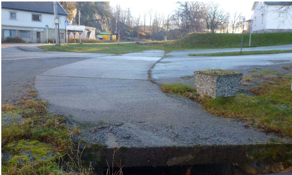
Figur 25. Lukking under Hasselvikveien er lang og vandringshindrende, men sjørret kan trolig passere i perioder med en noe høyere vannføring. Foto: Morten Bergan
