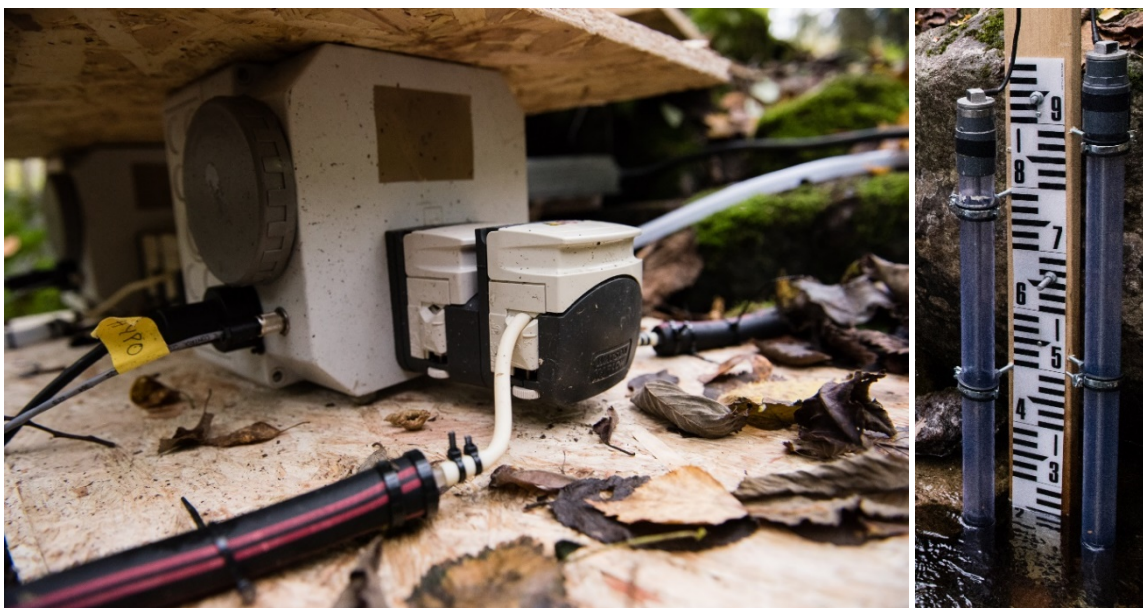
Figur 3. Vannstandsmålere (høyre) og peristaltiske pumper brukt til vannføringsstyrt dosering av kjemikalene. Foto: Anders Gjørwad Hagen/NIVA
