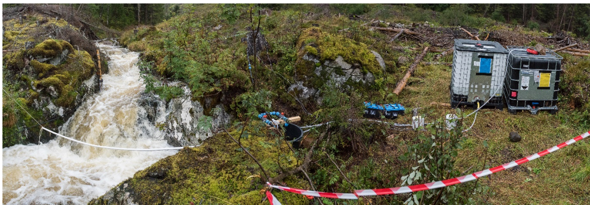
Figur 4. Doseringsstasjonen ved Lågåsbekken. Fra høyre til venstre: IBC-tank for henholdsvis hypokloritt og ammoniumklorid, peristaltiske pumper, batterier, blandkar, og rør for å lede ferdig blandet monokloramin ut til bekken. Foto: Anders Gjørwad Hagen/NIVA
