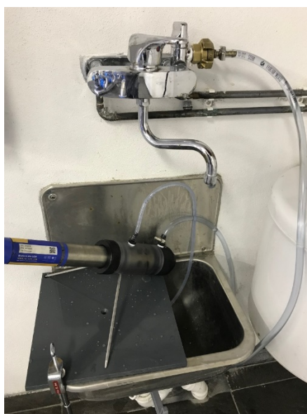
Figur 2. Tilkobling av sensorsystemet på Greivåsen HB.
