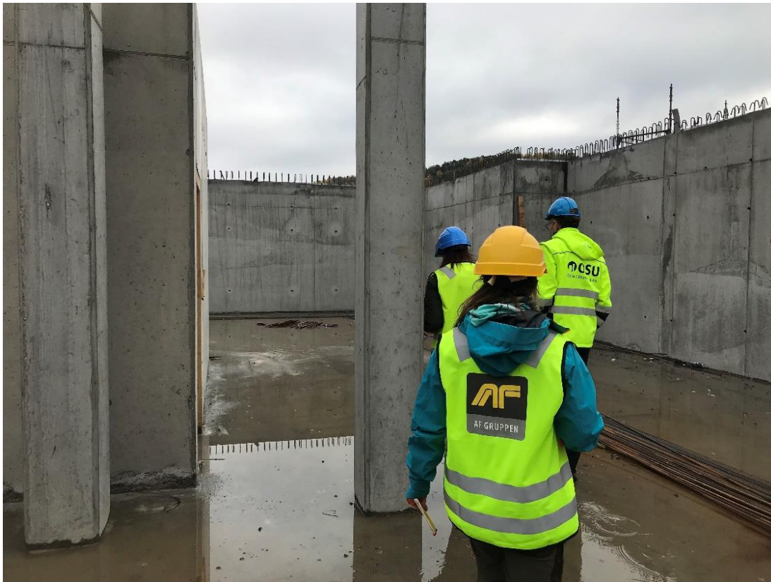
Figur 14. Et eksempel på bruk av glatte overflater og rette kanter ved utbygging i sjø, fra Bispevika B6a, før vannet slippes inn. Foto: Eli Rinde/NIVA, oktober 2018.
