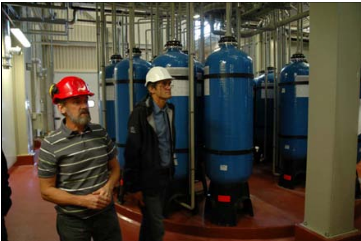
Figur 2. Renseanlegget ved gruva i Falun
