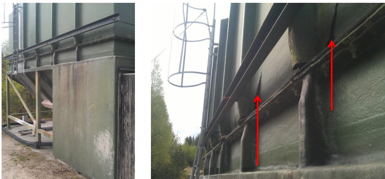
Figur 9. To fotoer som viser skadene på beholdningstanken ved Skåre doseringsanlegg. Det er gjort forsøk på å sikre mot total oppløsning av tankveggen ved å montere U-jern som anstivere med gjennomgående festestang gjennom tanken. Pilene viser store flerrer i skroget.
