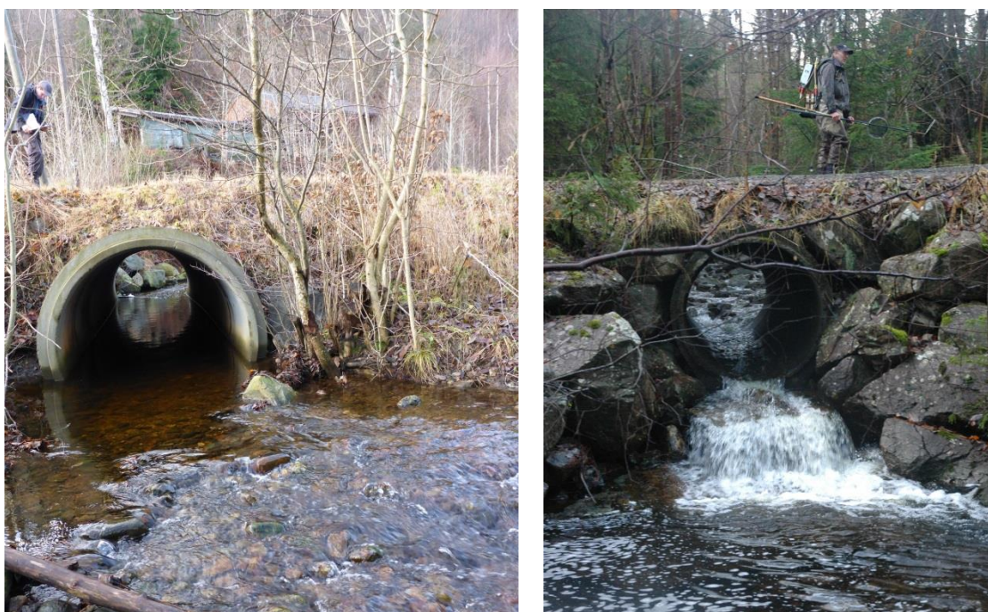
Figur 4. Songebekken har mange kulverter, noen er gode (v) andre er vandringsbarrierer (h)
