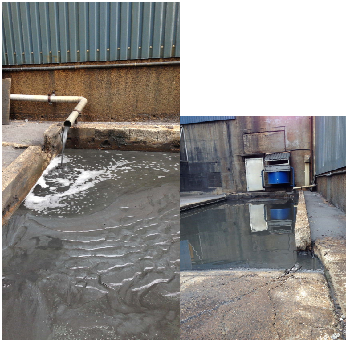
Figur 3. Rør for utslipp av vaskevann til utjevningsbassenget. Utløpet fra bassenget (høyre bilde) er et overløp i høyre hjørne i nærmeste bildekant.
