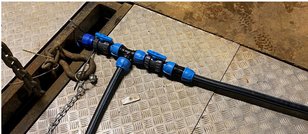
Figur 15 - Forgrening som fordeler doseringsløsning ned i sugerørslukene på Driva kraftverk
