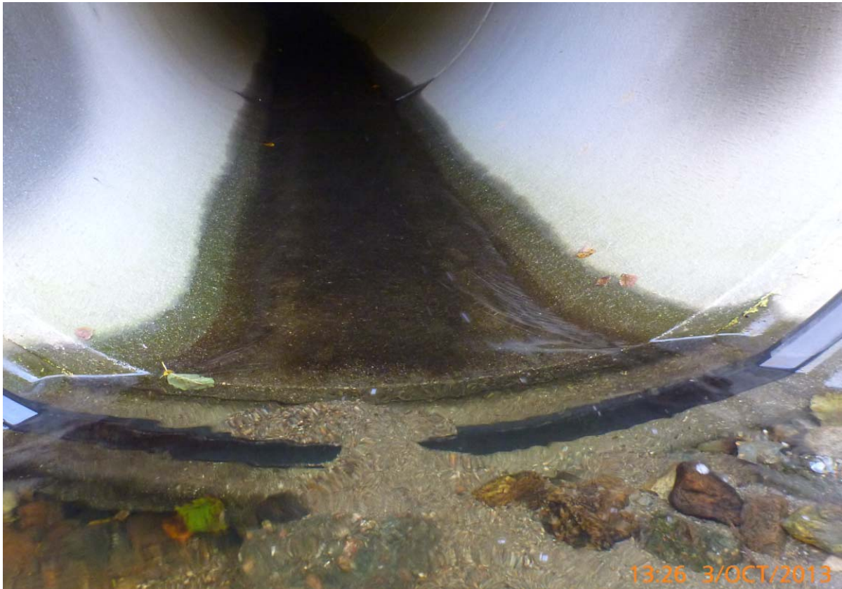
Figur 48. Kulvertinngang under Fv 231 i Karlsengbekken. Svært lite vanddyb i kulverten ved lave og middels vannføringer. (Foto: Morten Andre Bergan)
