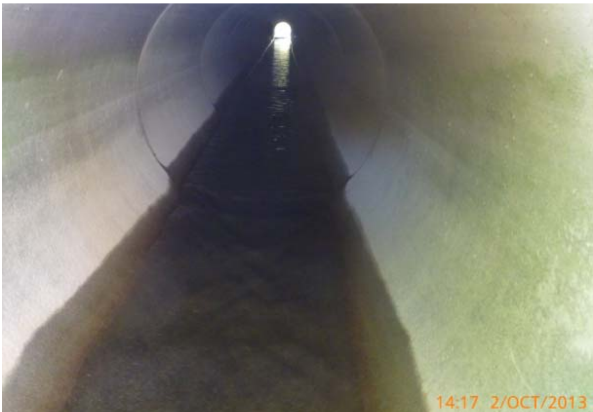
Figur 31. Krysning under Fv 710 hindrer ikke fiskevandringer. (Foto: Morten Andre Bergan).
