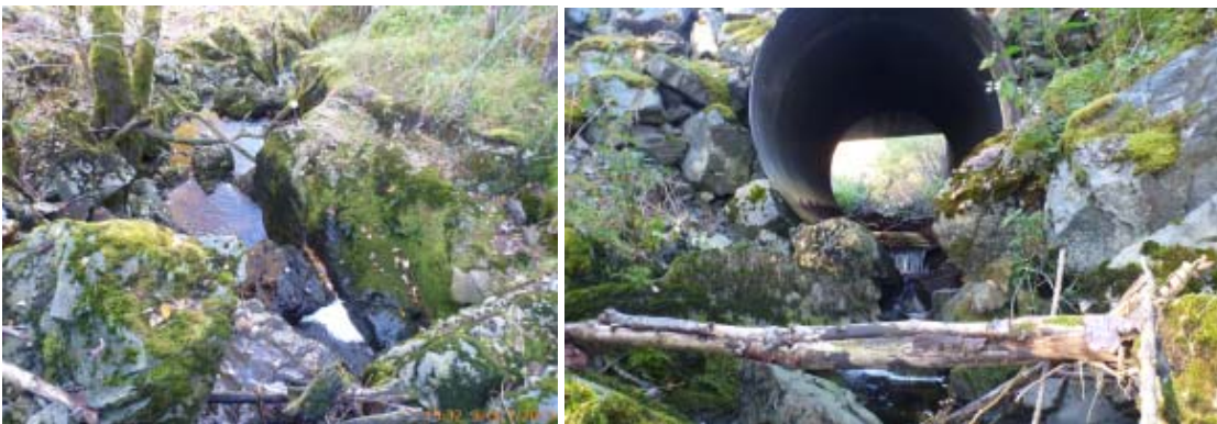
Figur 58. Bratt stigning i Kalvåbekken nedstrøms Fv 231 (t.v.), og blikk-kulvert under Fv 231. Det er svært vanskelige oppgangsforhold i dag, men vi mangler data/informasjon om det var mulig å forsere dette partiet for sjørret historisk. Det er godt egnede bekkestrekninger ovenfor veien, og en oppgang forbi dette partiet ville gitt betydelige produksjonsarealer for sjørret.
