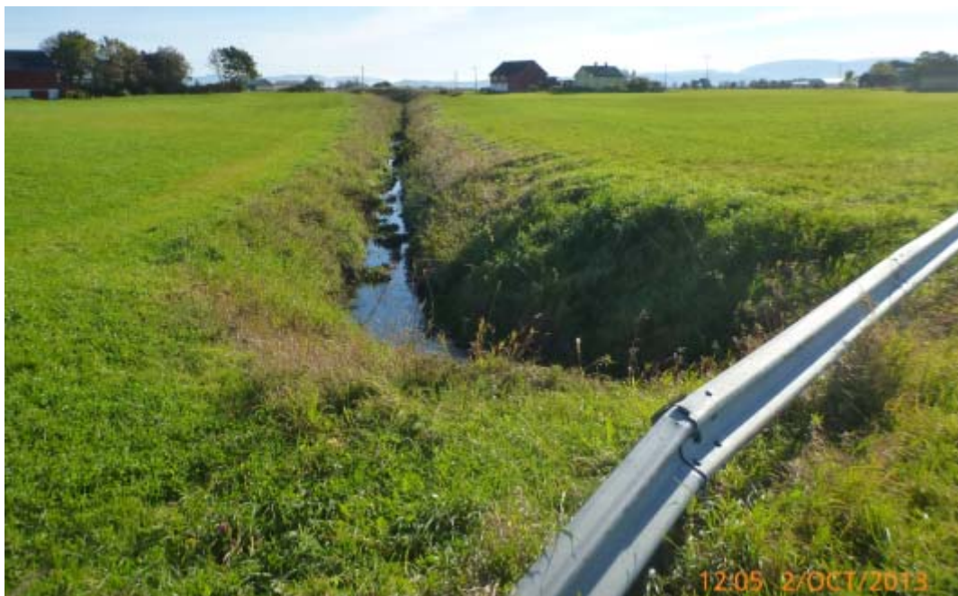
Figur 17. Meldalsbekken ovenfor Fv 243 i dag. Fotoet viser senket og utrettet kanal, lik hele dagens åpne strekning. (Foto: Morten Andre Bergan)
