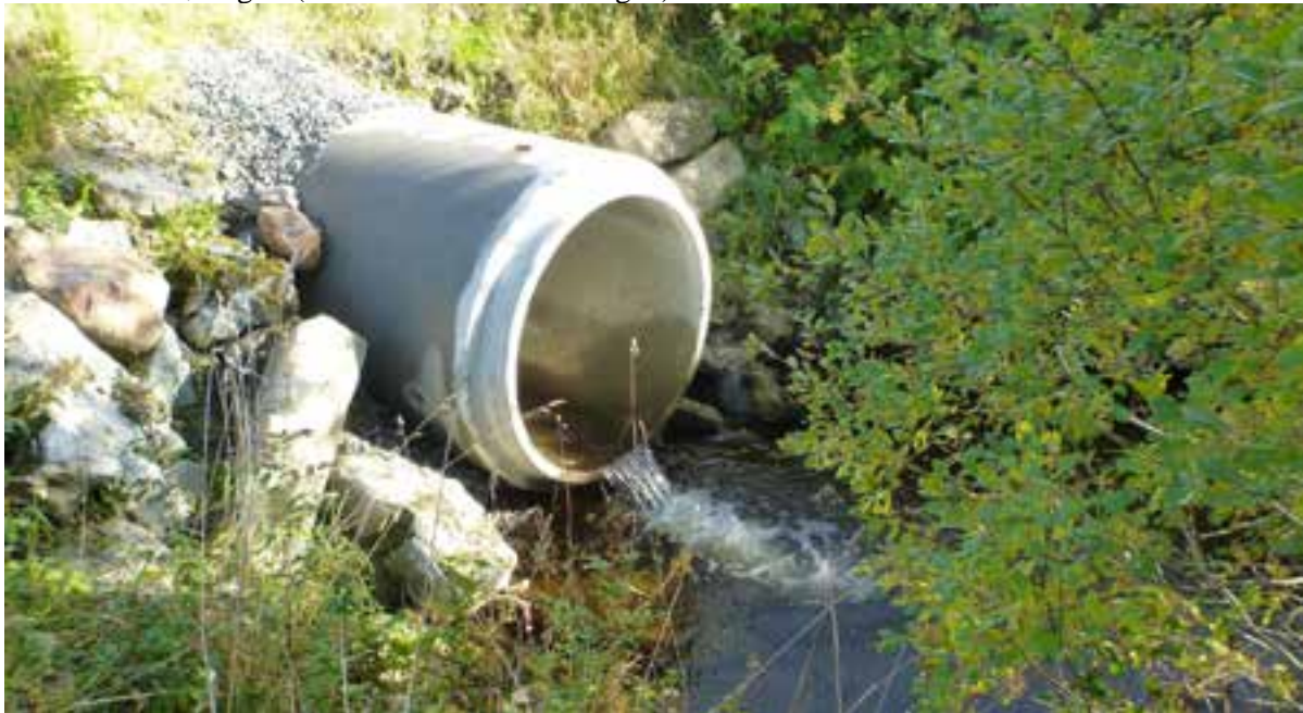
Figur 49. Kulvertutløp nedstrøms Fv 213 i Karlsengbekken. Sprang opp til kulvert på liten og middels vannføring. (Foto: Morten Andre Bergan)
