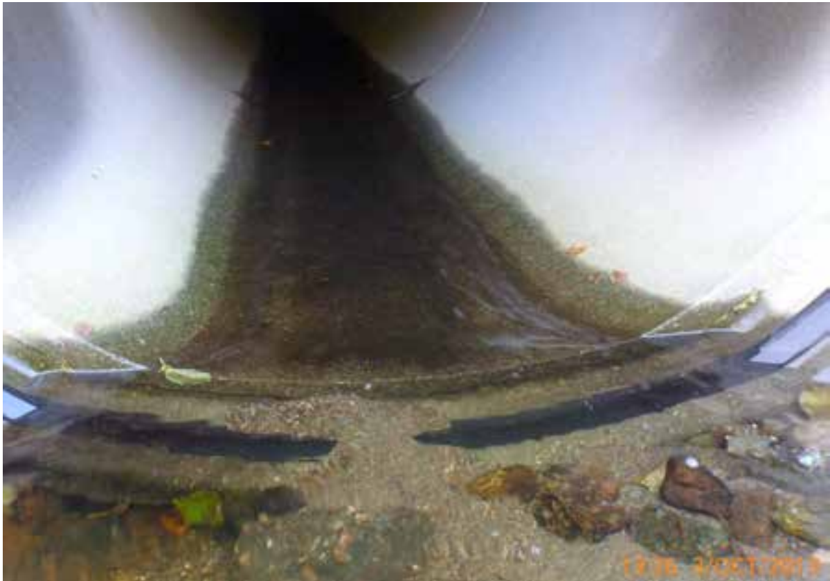
Figur 48. Kulvertinngang under Fv 231 i Karlsengbekken. Svært lite vanddyb i kulverten ved lave og middels vannføringer. (Foto: Morten Andre Bergan)
