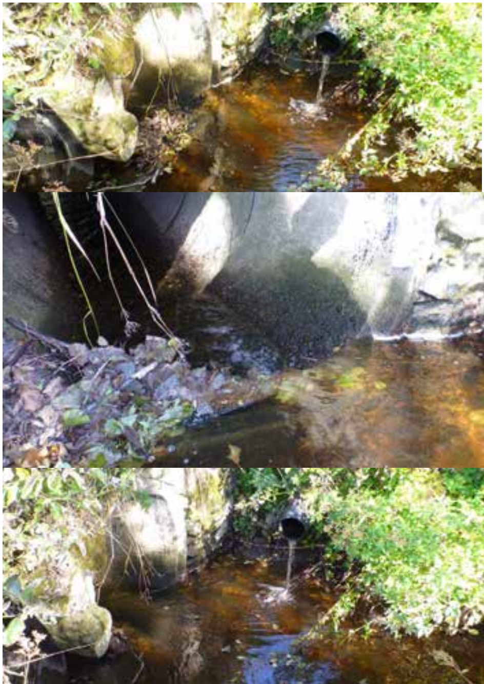
Figur 53. Nedre kulvert under Fv 231 var delvis tett som følge av ansamling av kvist/greiner/løv (øverst), noe som ga fall nedstrøms og oppstuvning av vann oppstrøms med lav vanndybde i kulverten (midten). Situasjoner som dette kan stanse oppvandring til de viktige gyteområdene ovenfor kulverten i Karlsengbekken. NIVA fjernet tiltettingen, og utbedret dette på stedet (nederst). Kulverten bør ettersees årlig. (Foto: Morten Andre Bergan).
