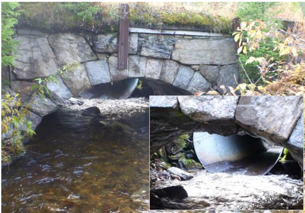
Figur 46. Oppøring foran kulvertinngangen kan etter hvert hindre eller stoppe oppstrøms fiskevandring. (Foto: Morten Andre Bergan)
