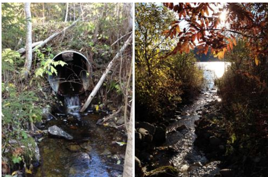
Figur 68. Kulvert under Fv 704 (t.v.) og Stamphusbekkens munning til Selbusjøen. (Foto: Hans Mack Berger).
