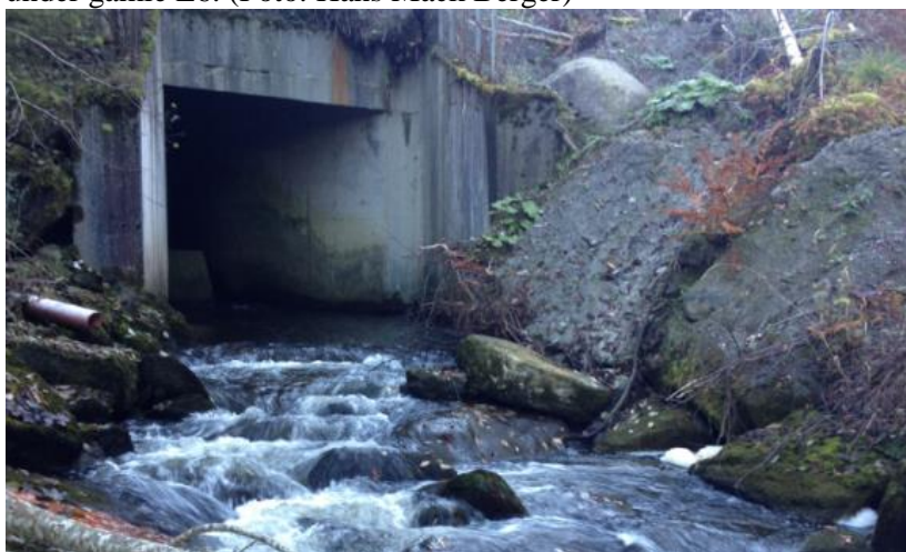
Figur 84. Kulvert ved Granheim er oppgangsbarriere for sjøørret, og har et fall på ca 3 meter inne i kulverten. Stasjonsområde 15c er nedstrøms kulverten. (Foto: Hans Mack Berger)
