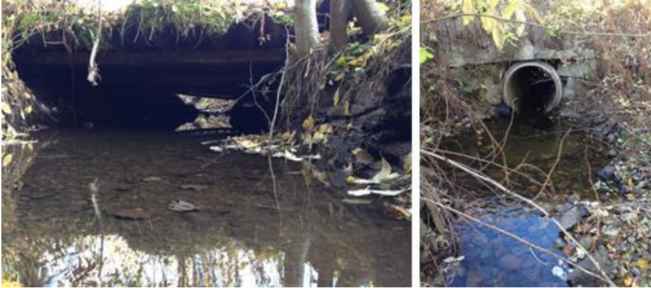
Figur 60. Kulverter under veier som krysser Brøttemsmobekken, hhv. under traktorvei (t.v.) og under Fv 926 (t.h.). Alle er tilfredsstillende utført mht fiskevandring. (Foto: Hans Mack Berger)
