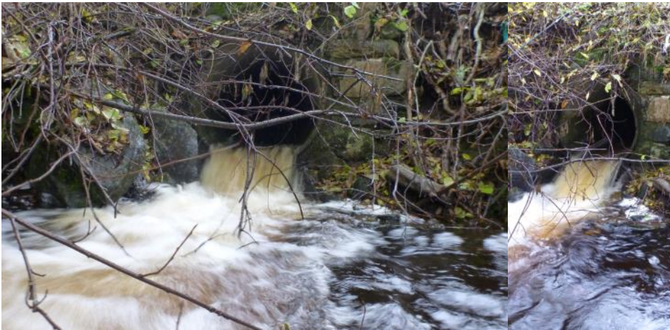
Figur 50. Kulvert under Fv 705 i Evjebekken er sterkt vandringshindrende eller vandringsbarriere. (Foto: Morten Andre Bergan).
