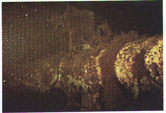
Fig. 78. Slamansamling ved ende av utløpsledning.
