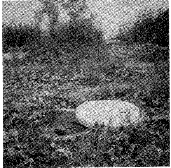
Råtnettanken ligger helt nedgravd inn- til selve renseanlegget, og på bildet sees én av varmespiralene som står ned i tanken.
