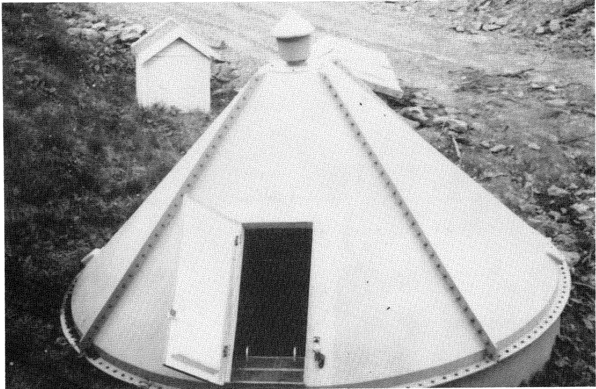
Krokbekken renseanlegg (i bakgrunnen oppholdsbrakke og overbygget innløpskum).
