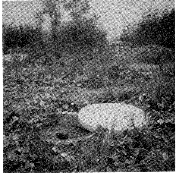
Råtnetanken ligger helt nedgravd inn- til selve renseanlegget, og på bildet sees én av varmespiralene som står ned i tanken.
