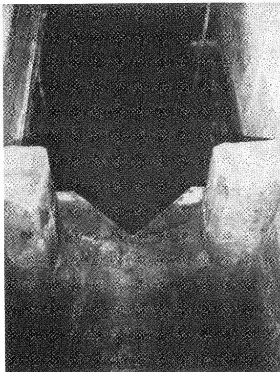
Utløpskum med V-overløp. Avstanden fra spissen på overløpet og ned til betongterskelen er for liten.
