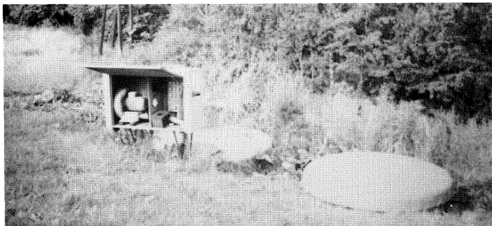
Lånke aldershjems renseanlegg. Eksteriør med høytrykksvifte og sikringsskap
