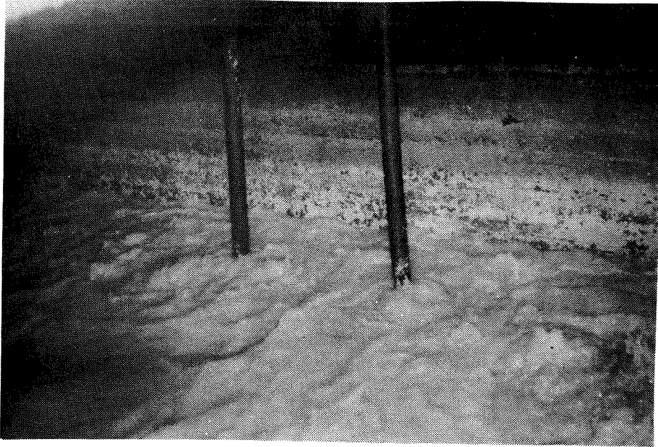
Figur 8b. Foto av luftet utjevningssasseng.
