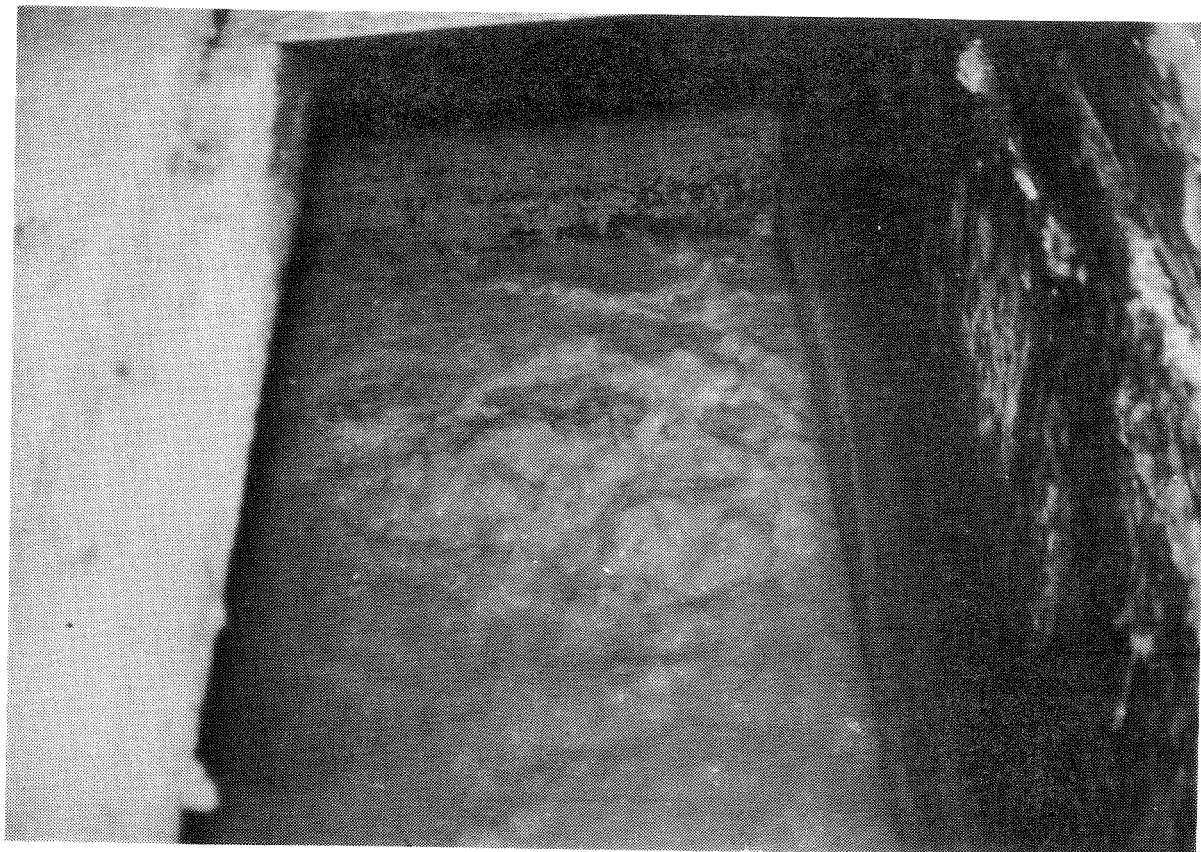
Figur 3. Luftet utjevningssasseng for meieriavløp.
