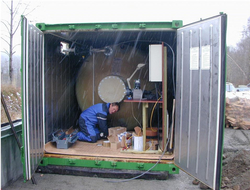
Figur 20. Foto av silikatdoseringsanlegget i Logåna (Mandalsvassdraget) som viser den ytre kjølecontaineren, styringsenheten, den indre silikattanken.
