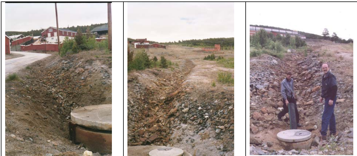
Figur 14. Drensgrøfter i Folldal sentrum (nedenfor saga, fra "Dueslaget" og nedenfor Norø). I disse grøftene kan det observeres stillestående, surt vann som ikke kommer fram til oppsamlingskummene.
