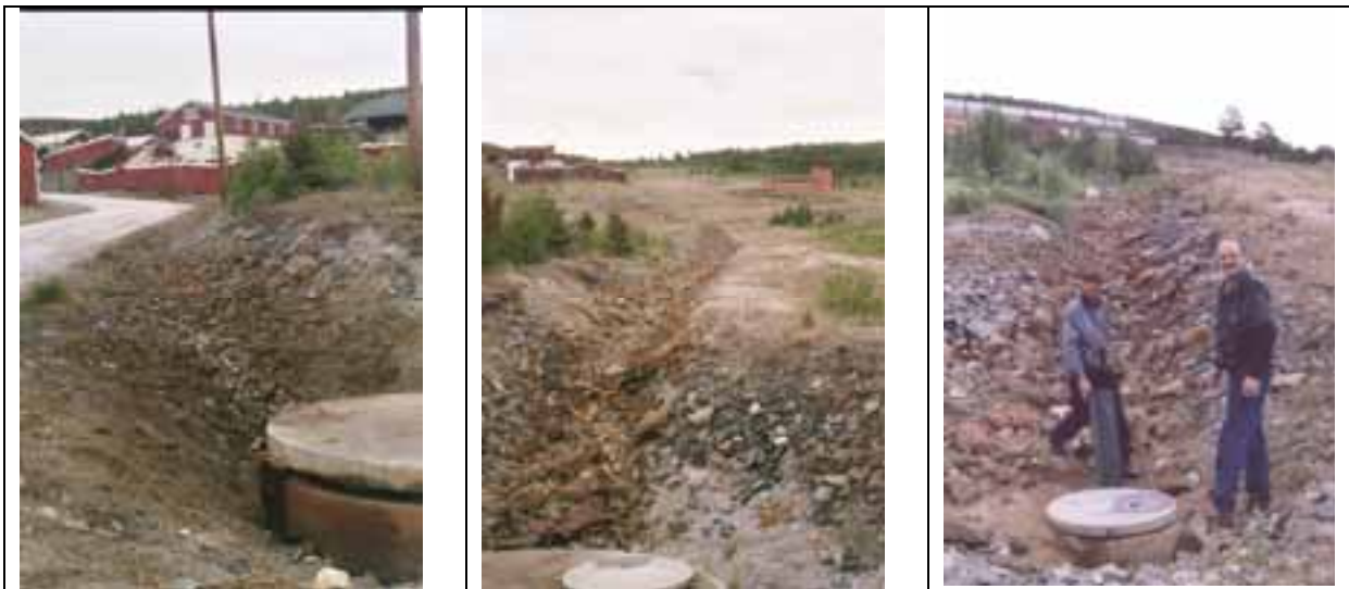
Figur 14. Drengrøfter i Folldal sentrum (nedenfor saga, fra "Dueslaget" og nedenfor Norø). I disse grøftene kan det observeres stillestående, surt vann som ikke kommer fram til oppsamlingskummene.
