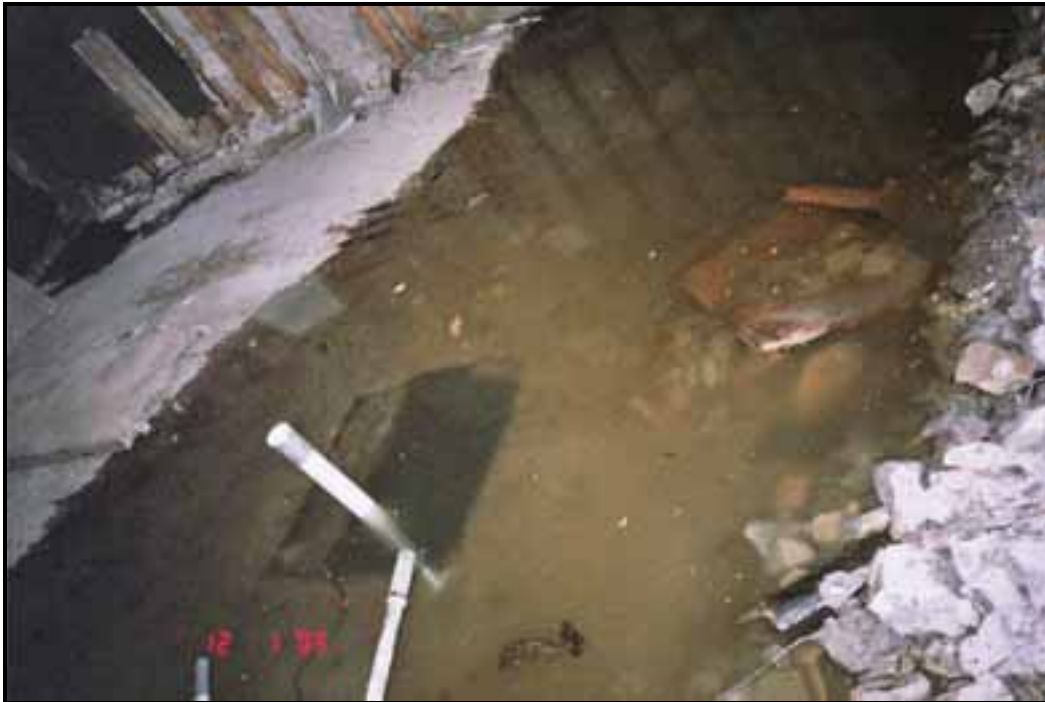
Figur 8. Frå fiskebutikken under springfloa 12. januar 2005. Vannstandsmålaren (sensoren) blei etter dette plassert ned i målebrønna (brønn MB9). Manuell måling av salinitet blei også gjort i denne brønna i perioden 10. mars – 29. april 2005.
