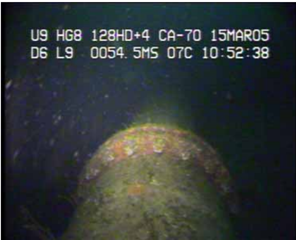
Figur 16. Parti av avløpsrøret, nær diffusoren.
