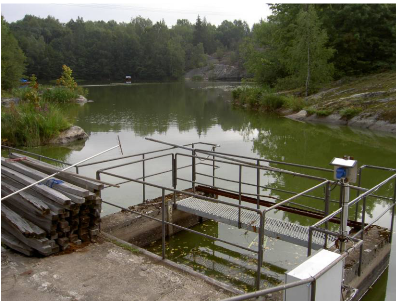
Figur 6. Plassering av sonden ved inntaket til prosessvann til Petterson fabrikker; Moss dam til høyre, utenfor bildet. Foto: Eva Skarbøvik.
