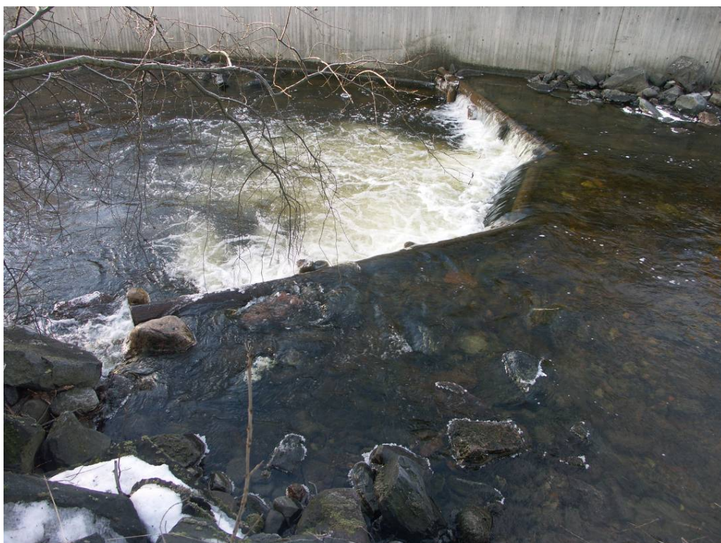
Figur 20. Terskel nedstrøms fisketrappa. Terskelen bør repareres slik at vannet renner over terskelkrona ved liten vannføring. "Hullet" i terskelens østre side (nederst på venstre i bildet) bør sikres men ikke tettes siden det gir små fisk mulighet til å vandre oppover vassdraget ved lav vannføring.
