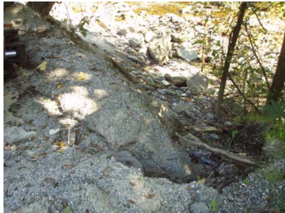
Erosjon i kanten
