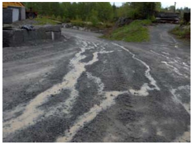
10. Ved regnvær eroderes det fra alle disse arealene, inkludert fra alle grusvegene
