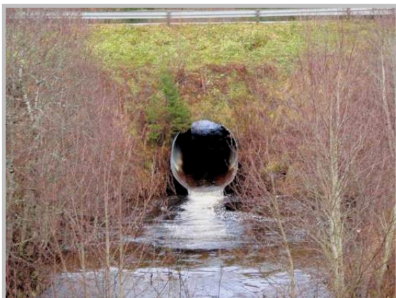
Figur 27: Kulvert under RV 12 i Kvitnesbekken., med vannføring over middels (Foto M. A. Bergan).
