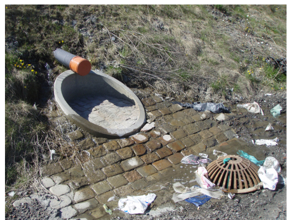
Overløpsrør avstengt, vegkum med rist
