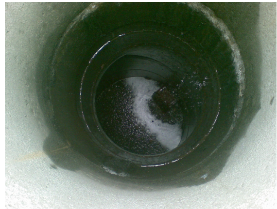
Kum nord med overløpsrør og innlekking
