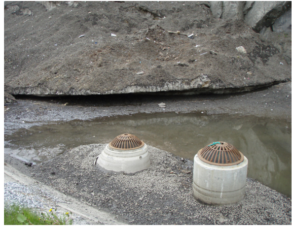
Kummer i renseanlegget
