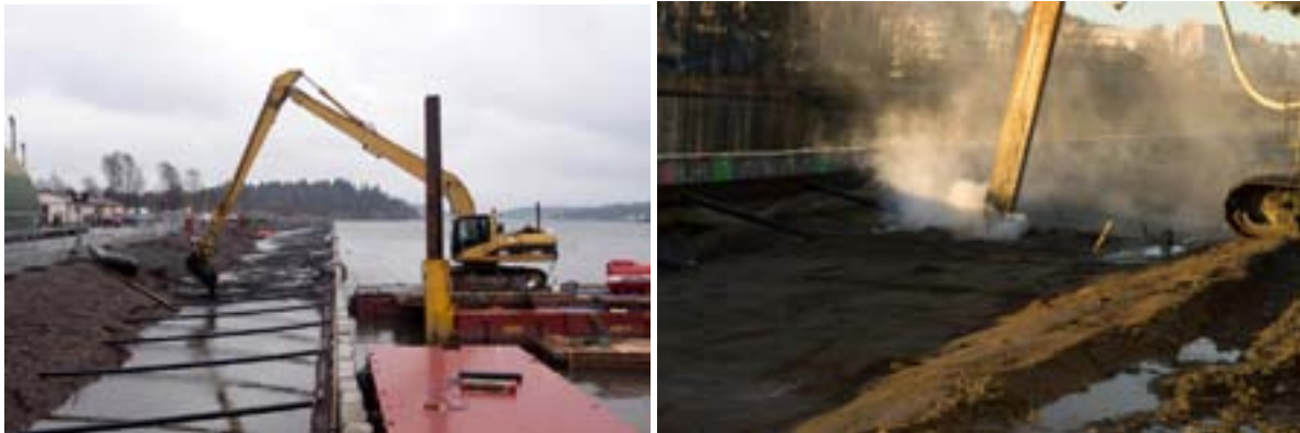
Figur 1. Sandvikselva ble mudret i perioden 25. november 2008 til 21. januar 2009. Mudringsmassene ble lagt bak en 342 m lang bentongspunt mot elveløpet som vist på bildet til venstre. Etter endt mudring ble massene STSO-behandlet på stedet, bak spunten som vist på bildet til høyre. Behandlingen var ferdig ved utgangen av januar 2009.
