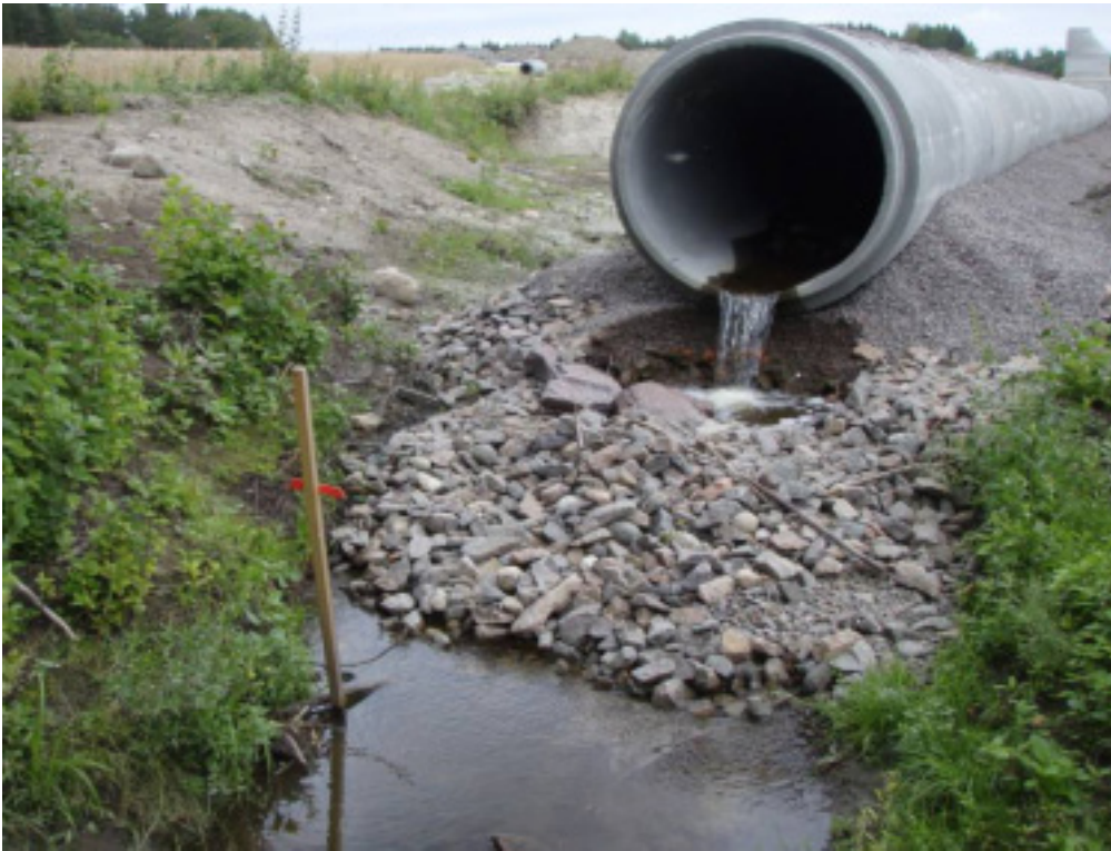
Figur 10. Nyanlagt kulvert over sjøørretførende bekker i Tønsberg, i forbindelse med anlegging av ny trase for Sørlandsbanen i 2009. Vil sjøørreten passere her på høyere vannføring eller flom?
